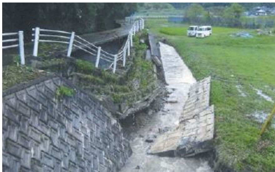
水路の被災(7月 岡山県真庭市)
