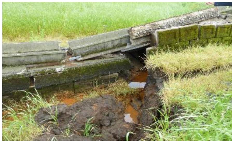
地震による用水路の被災(4月 熊本県阿蘇市)
