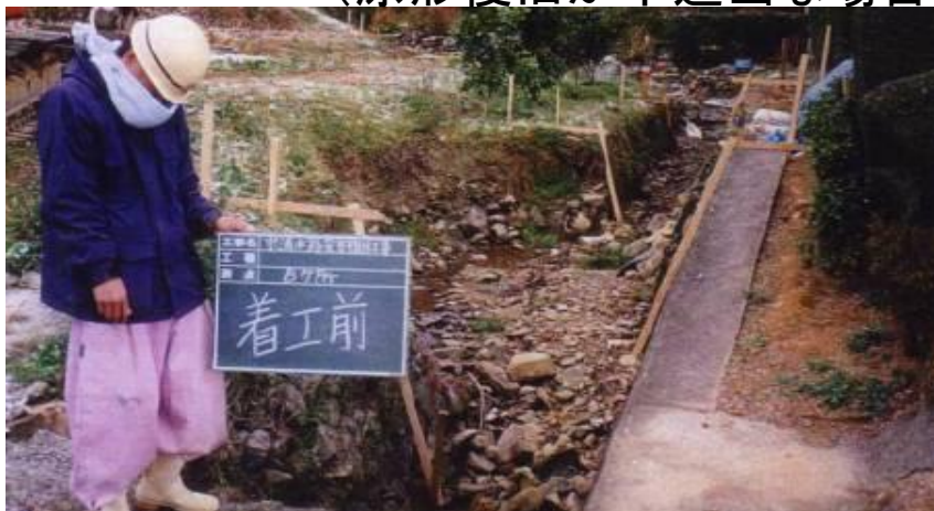
用排兼用水路護岸が被災
