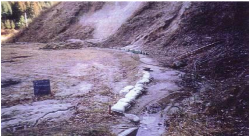
斜面崩壊土砂が流入し水路が埋そく
