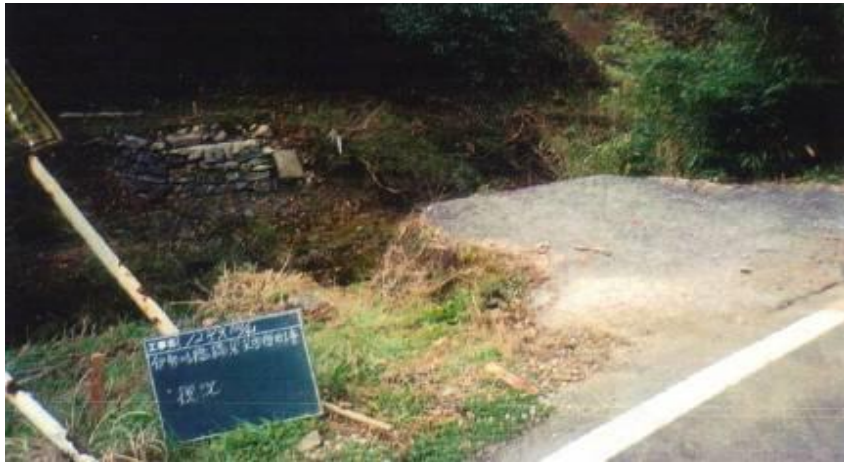
異常出水により木造橋が流失
