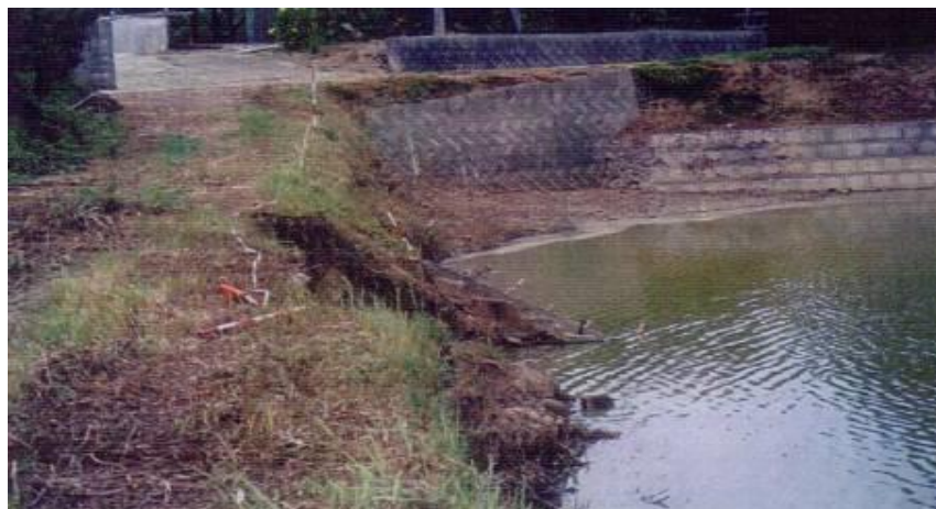
異常出水により斜樋、底樋が被災
