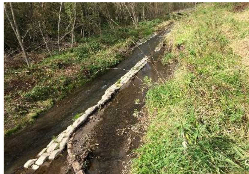
排水路の被災(8月 台風11号 北海道標茶町)
