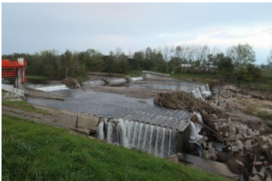
頭首工の被災(8月 台風10号 北海道鹿追町)
