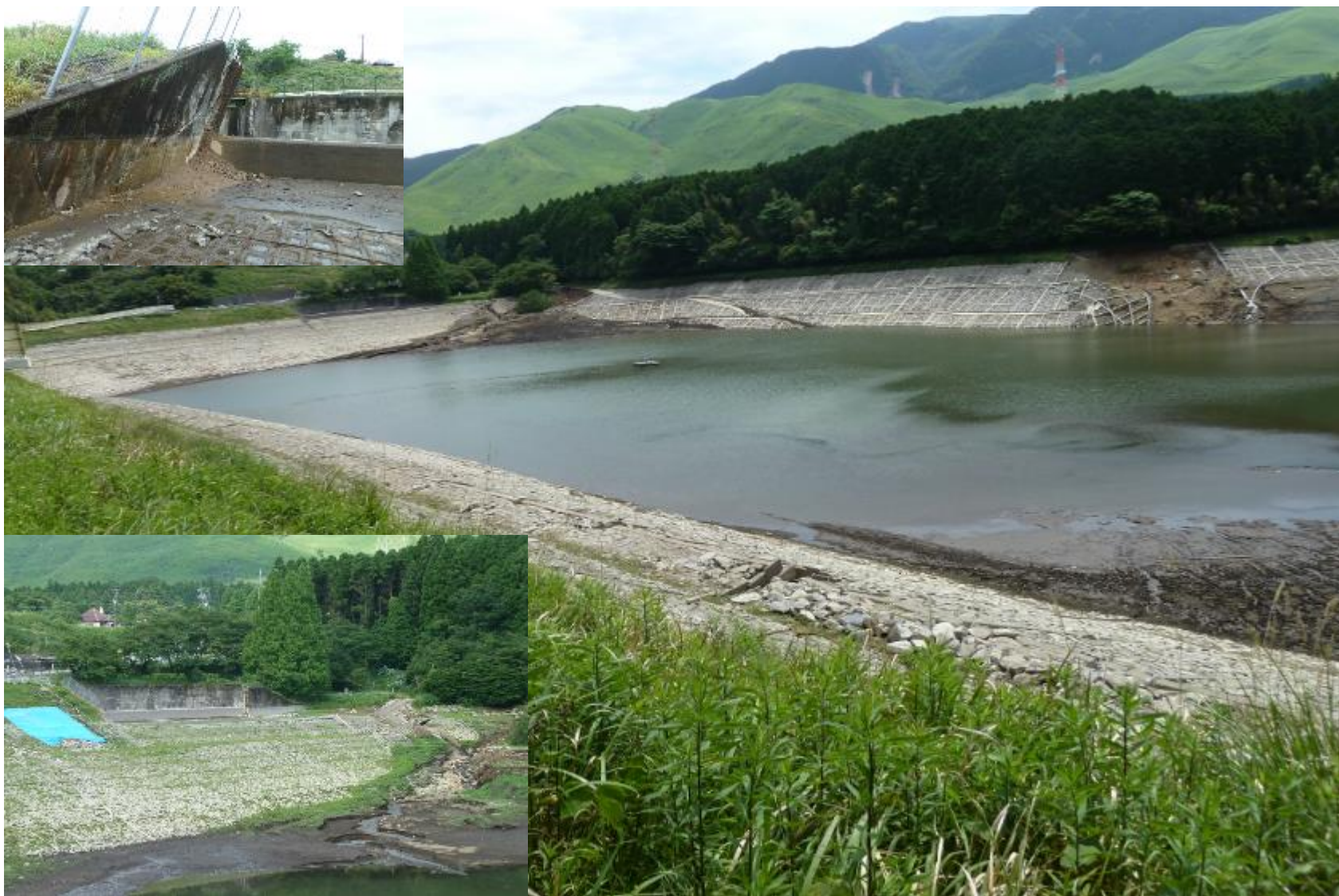
地震によるため池の被災(4月 熊本県西原村)
