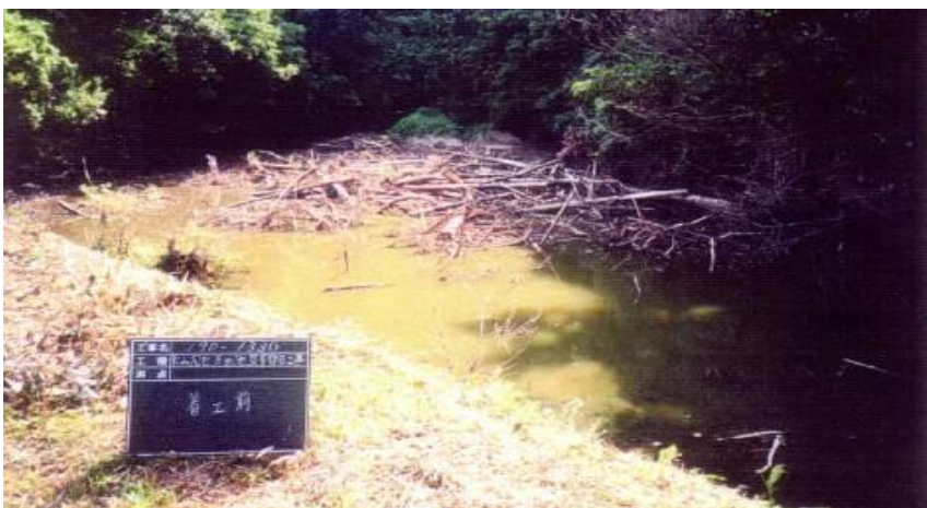
豪雨により土砂及び流木が流入
