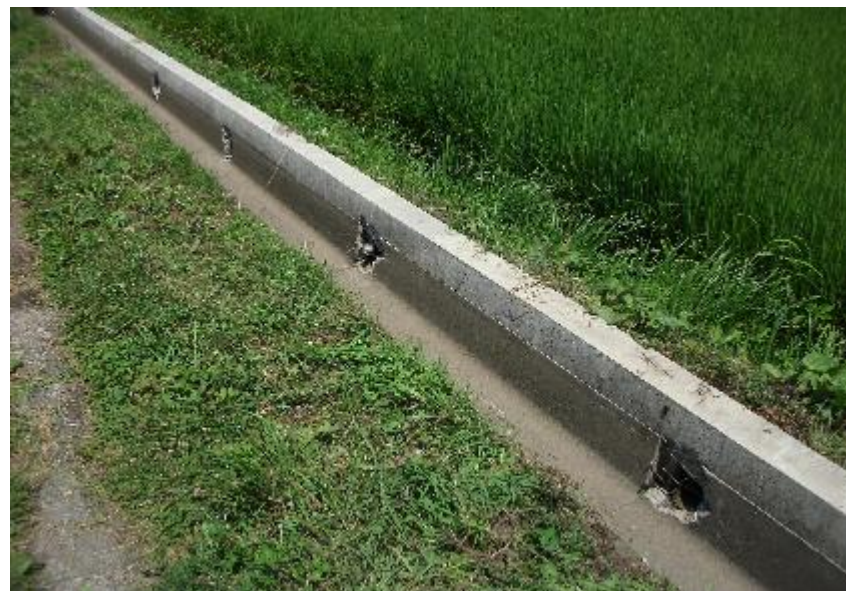
用水路継目部欠損(8月 落雷 千葉県木更津市)
