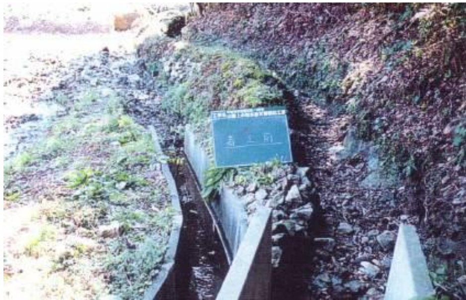
空石積み水路が洗堀され崩壊
