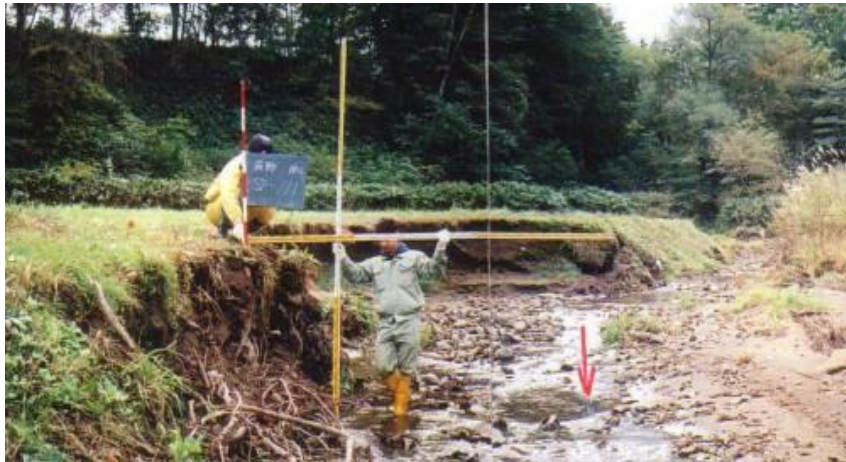
豪雨により排水路法面が崩壊
