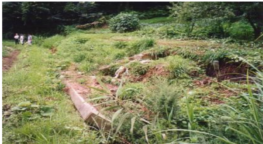
排水路護岸兼用の擁壁が転倒
