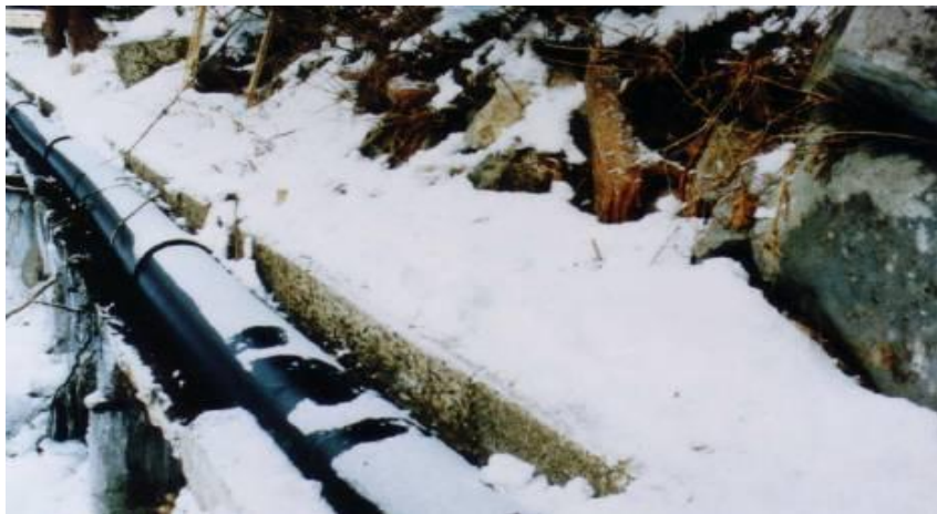
河川増水により現場打水路が被災
