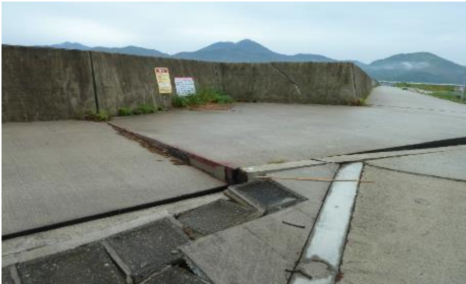
農地海岸施設の被災(熊本地震 4月 熊本県熊本市)
