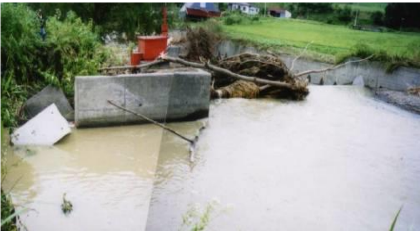
豪雨により、操作部及び護岸が被災
