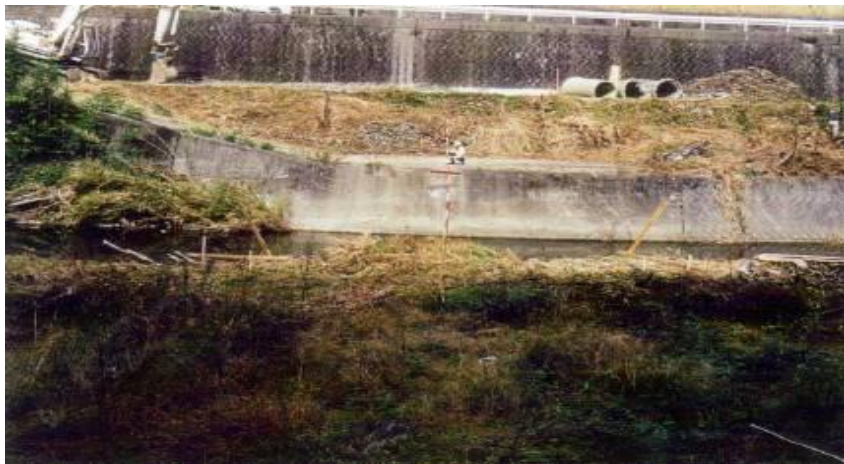
河川増水により鋼橋が流失
