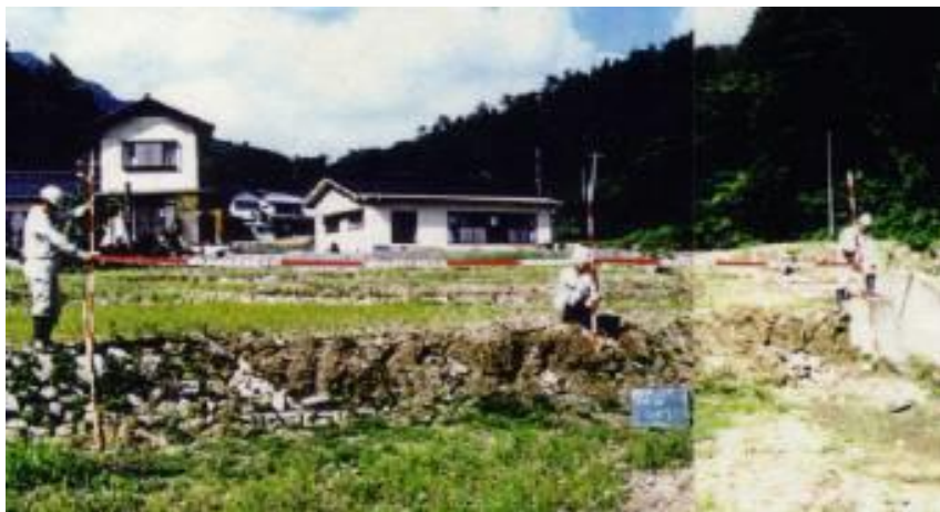
豪雨により石積畦畔崩壊
