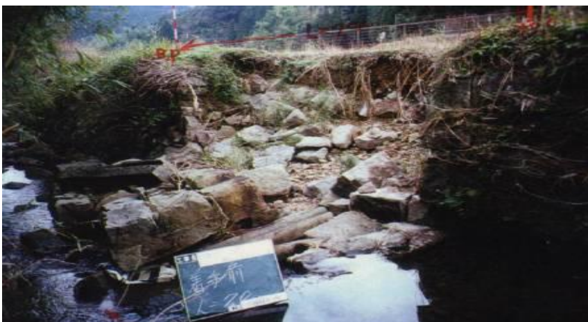
豪雨により頭首工護岸が被災
