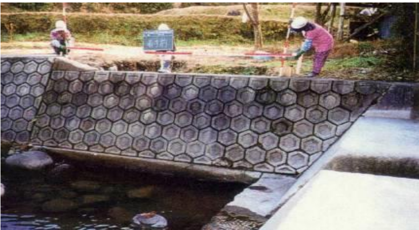
河床が深掘れし、ブロック基礎が露出
