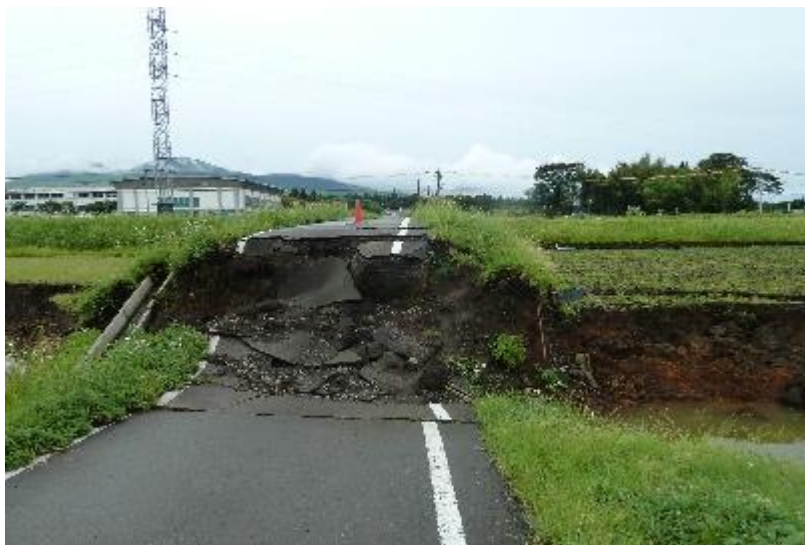
地震による農道の段差(4月 熊本県阿蘇市)
