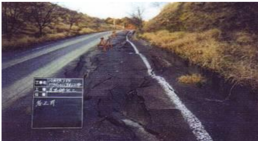
豪雨により路盤及び舗装が被災
