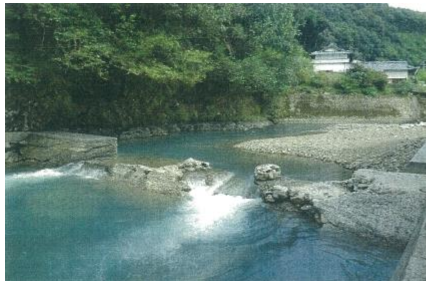
頭首工の被災(9月 台風16号 宮崎県門川市)
