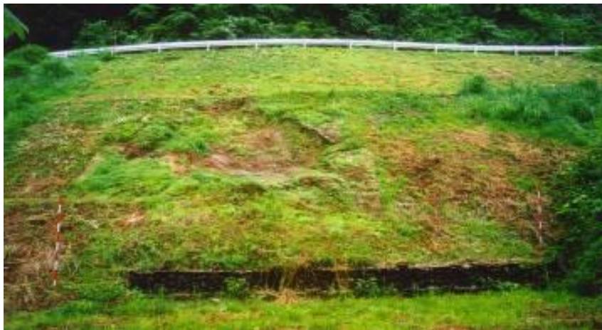
豪雨により道路法面崩落
