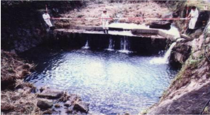
豪雨により深掘れし、水叩部が流失
