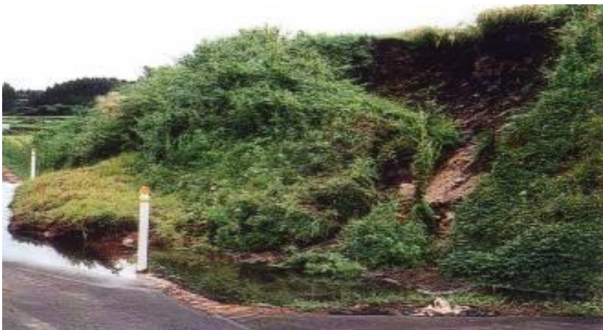
道路法面の崩落
