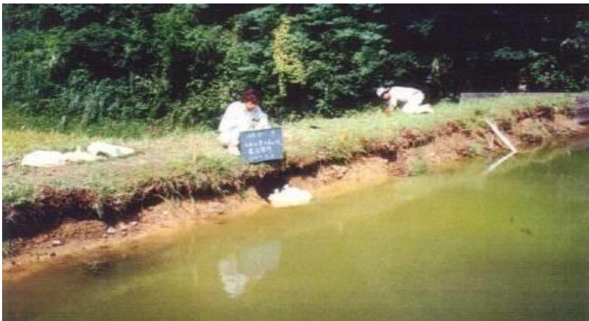
前法面が滑落し、堤体に空洞発生
