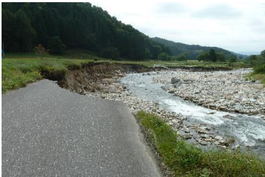
頭首工の流失(8月 台風10号 岩手県遠野市)
