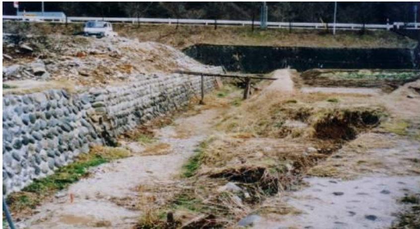
河川氾濫により用水路に土砂堆積
