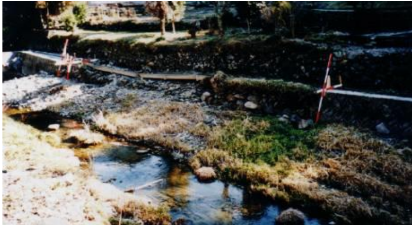
河川の氾濫により水路、護岸が被災
