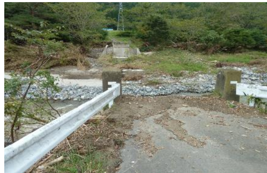
農道橋の流失(8月 台風10号 岩手県釜石市)
