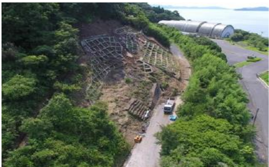
農道の被災(6月 梅雨前線 山口県光市)
