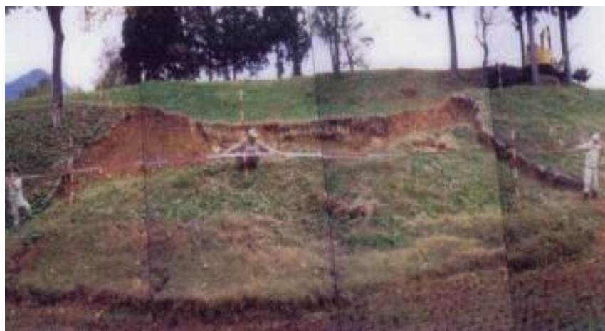
豪雨により畦畔崩壊
