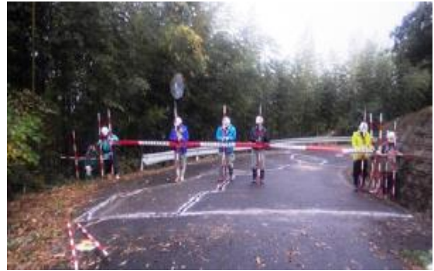
農道路面クラック及び陥没(10月 鳥取県中部地震 鳥取県湯梨浜町)
