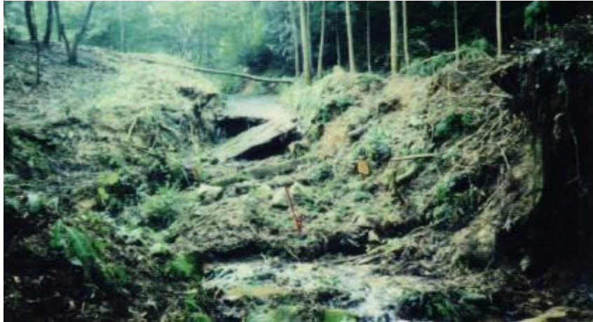
豪雨により余水吐水路が被災
