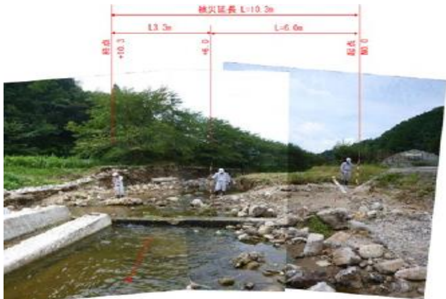
頭首工の被災(7月 島根県大田市)
