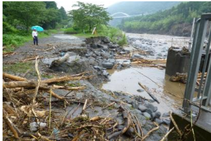
頭首工の被災(6月 梅雨前線 熊本県大津町)
