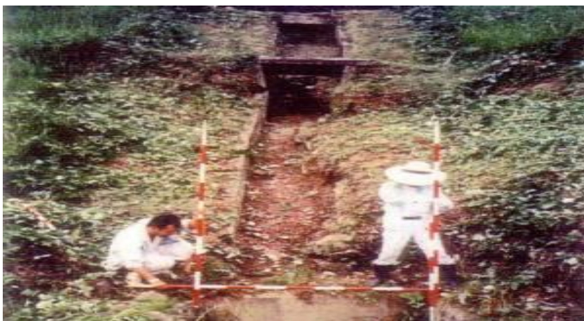
豪雨により余水吐が被災
