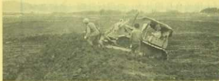
県営ほ場整備事業第1号・二井田地区(大館市)の整地作業 写真提供：秋田県農林水産部 農地整備課
