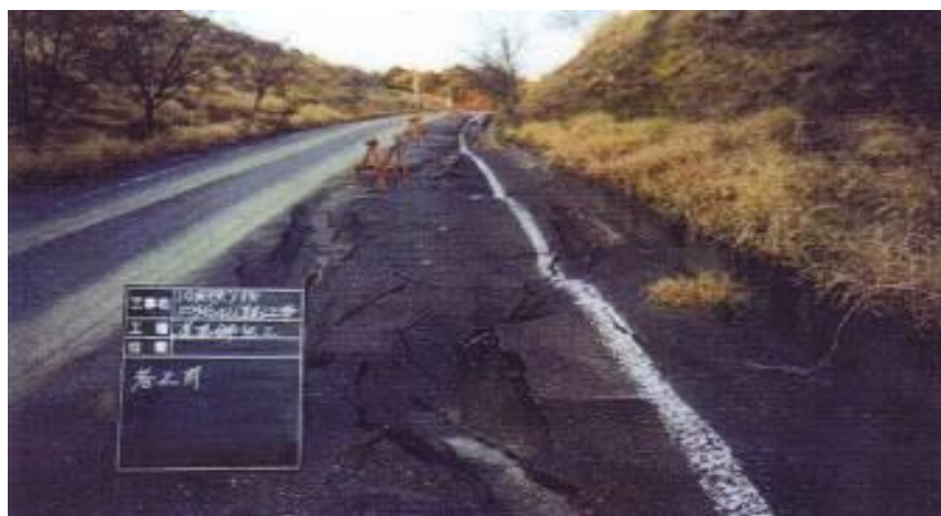
豪雨により路盤及び舗装が被災
