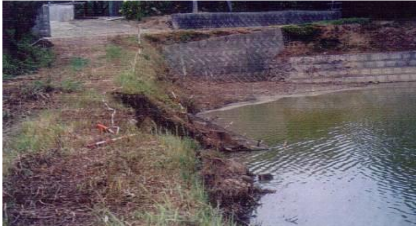
異常出水により斜樋、底樋が被災
