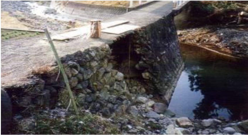
豪雨により石積法面崩壊
