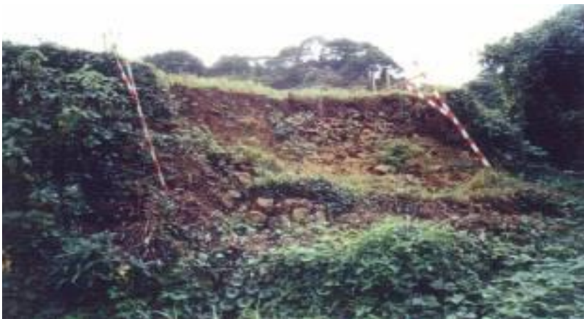
豪雨により畦畔崩壊
