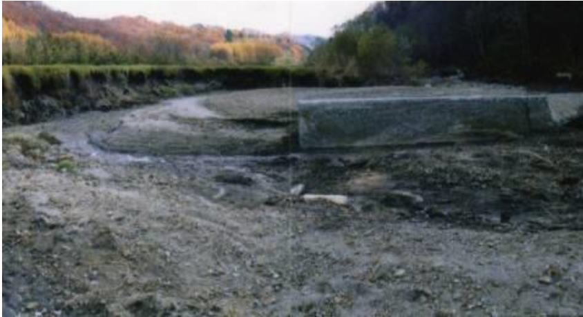
豪雨により頭首工左岸部が被災
