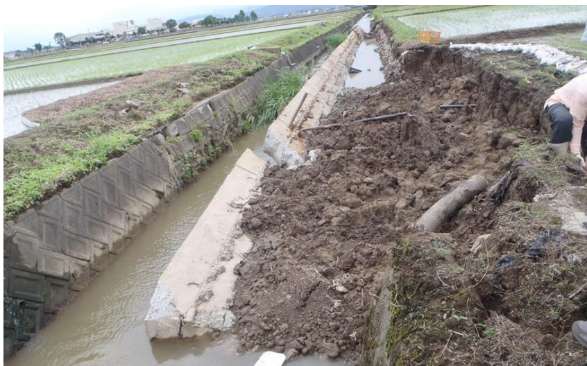
排水路の被災(7月 梅雨前線 熊本県熊本市)
