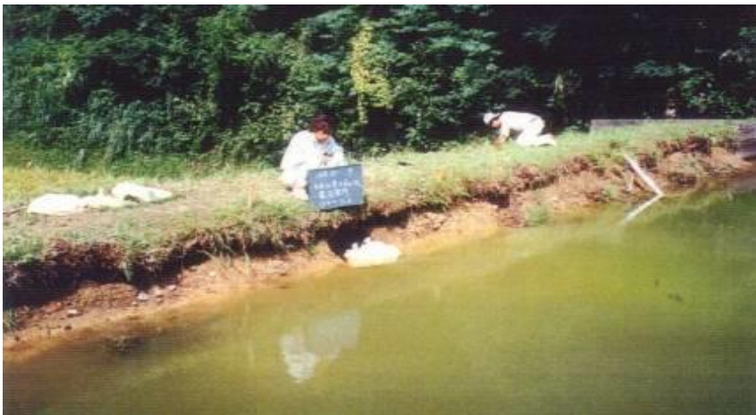
前法面が滑落し、堤体に空洞発生
