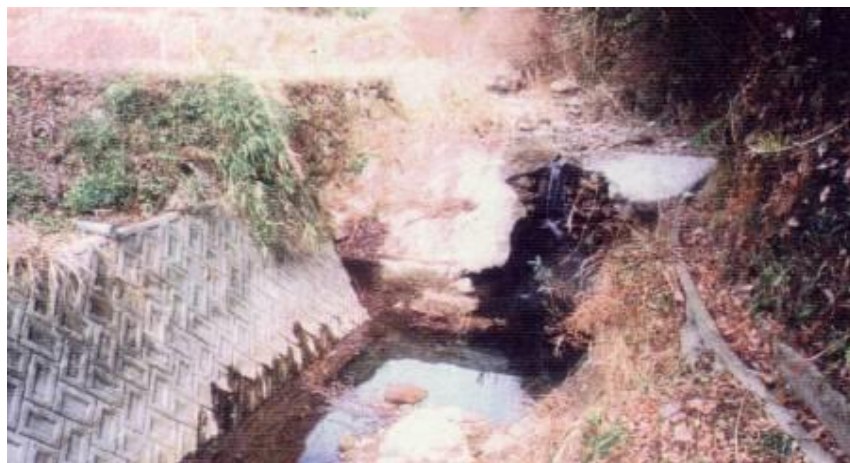
豪雨により練石積堰が洗堀
