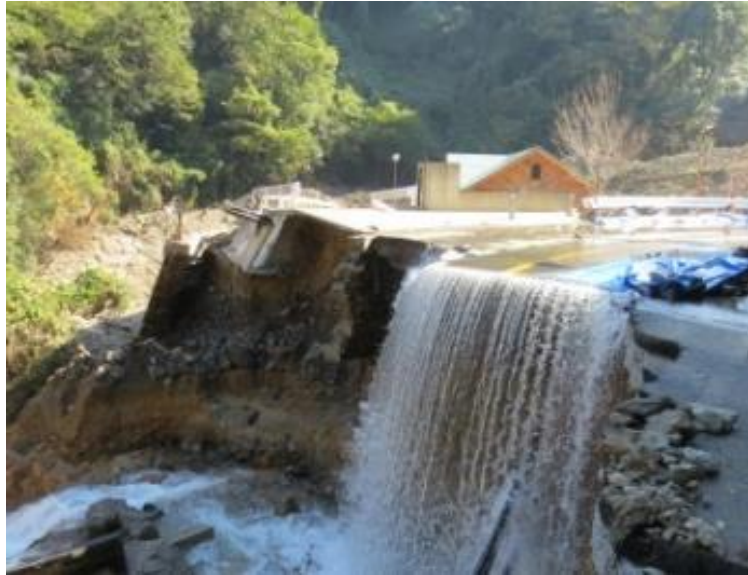
集落排水施設の被災(10月 台風21号 大阪府岸和田市)
