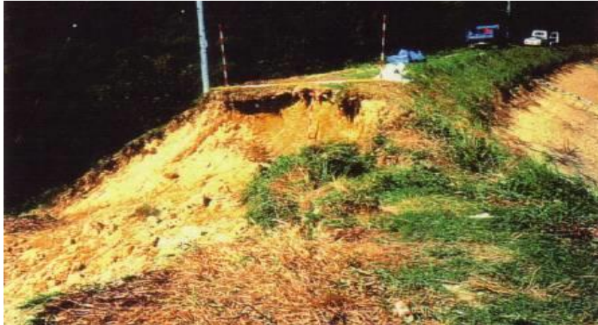
後法面が滑落しパイピングが発生
