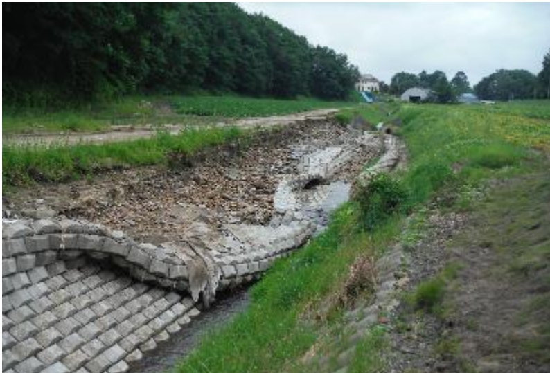
排水路の被災(7月 梅雨前線 北海道訓子府町)
