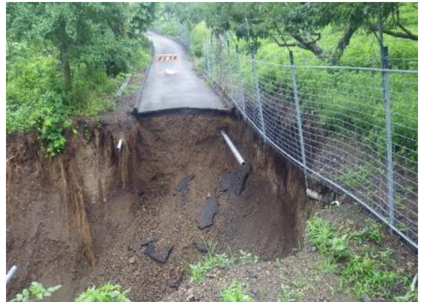
農道の被災(6月 梅雨前線 三重県御浜町)
