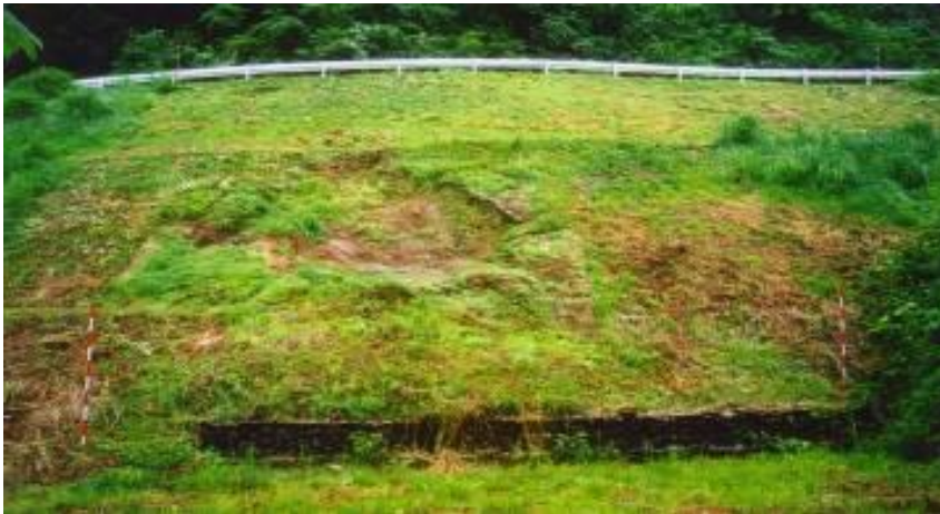
豪雨により道路法面崩落
