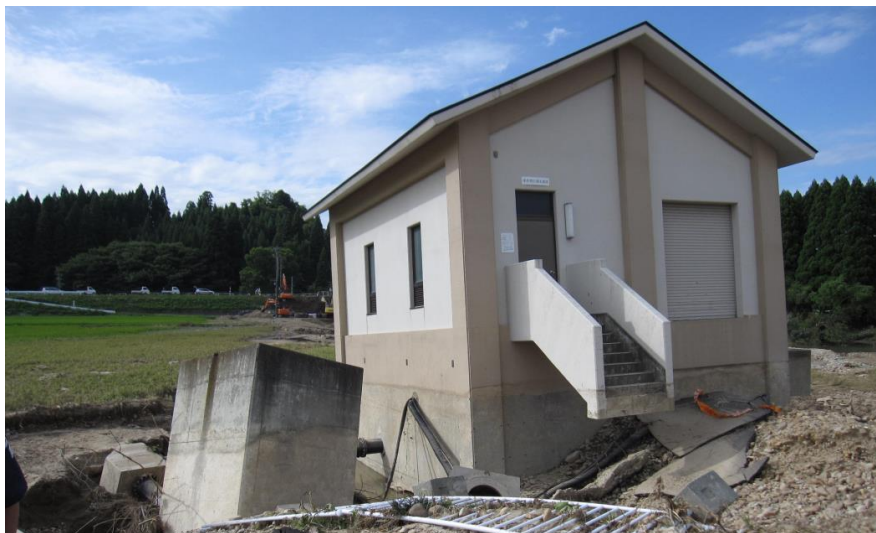
揚水機場の被災(7月 梅雨前線 秋田県大仙市)
