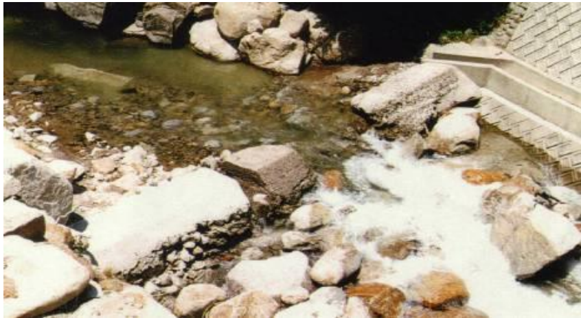
豪雨により堤体及び護岸が崩壊
