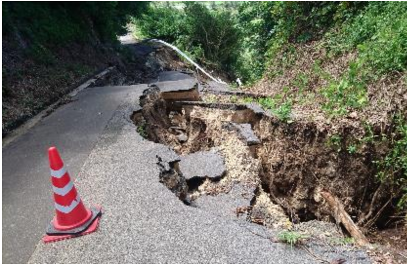
農道の被災(9月 台風18号 鹿児島県喜界町)
