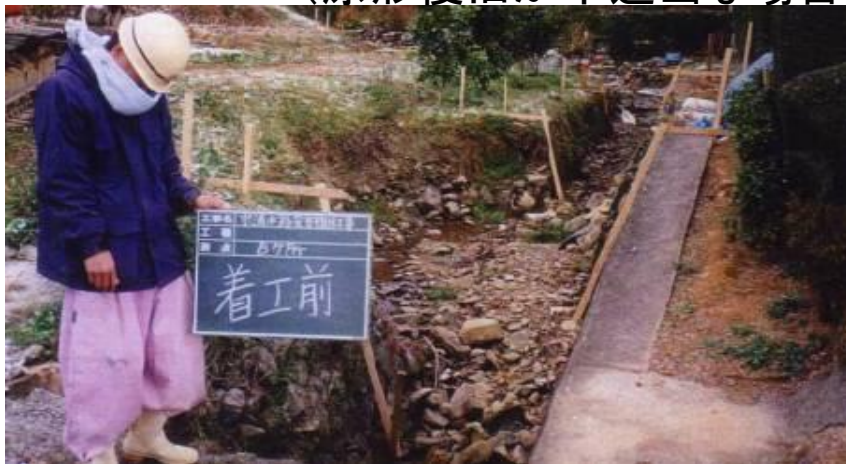
用排兼用水路護岸が被災
