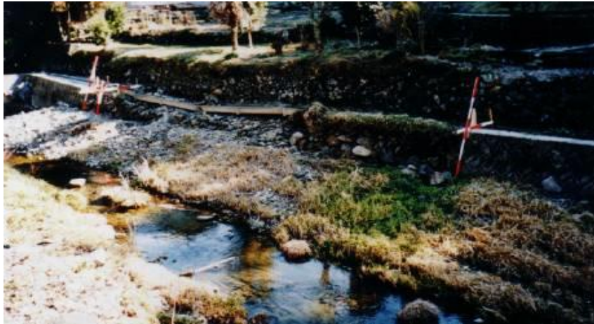
河川の氾濫により水路、護岸が被災
