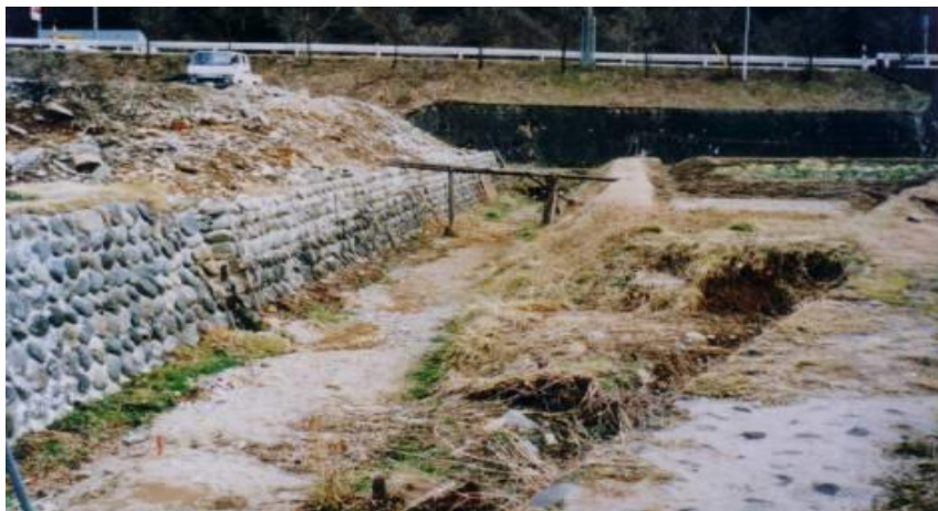
河川氾濫により用水路に土砂堆積
