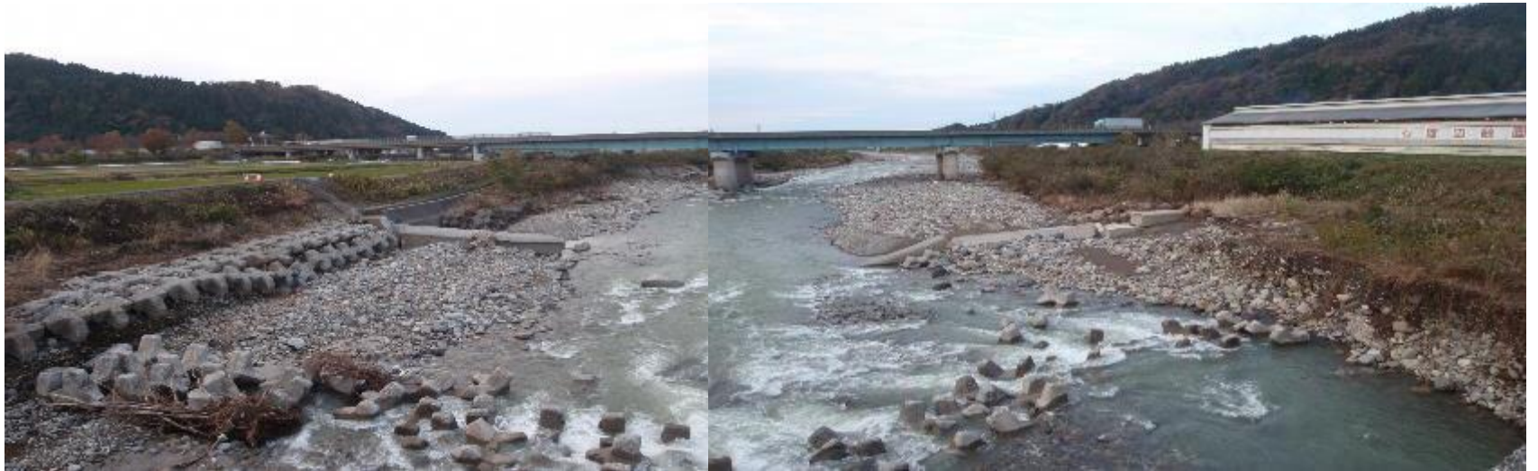
頭首工の被災(10月 台風21号 新潟県糸魚川市)
