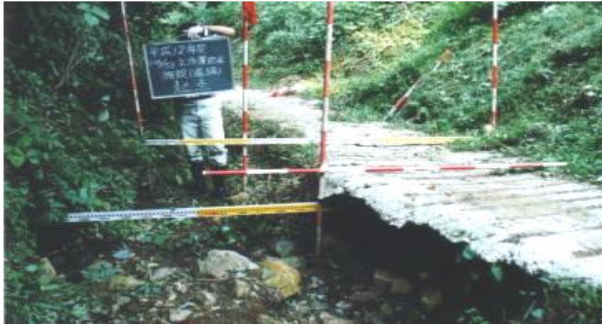
排水路護岸兼用の道路法面崩壊
