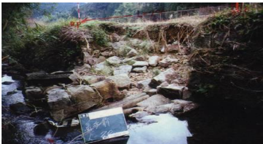
豪雨により頭首工護岸が被災
