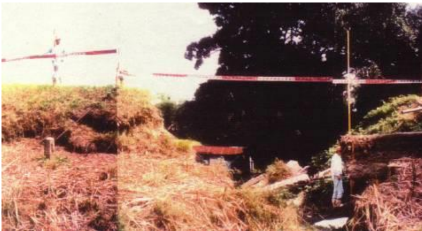
余水吐及び堤体の一部が決壊
