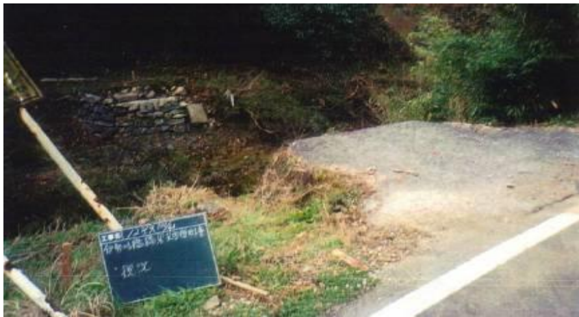
異常出水により木造橋が流失
