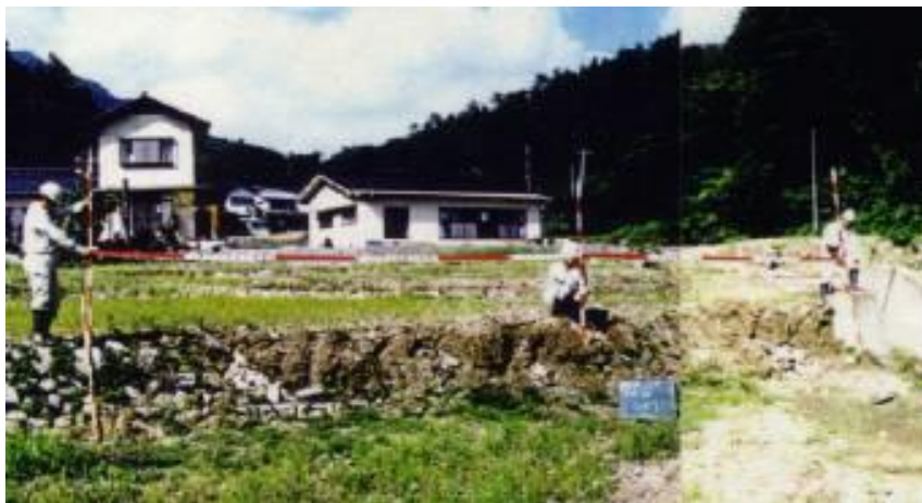
豪雨により石積畦畔崩壊
