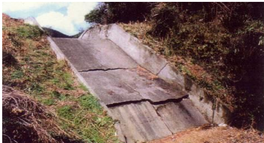
豪雨により余水吐が被災
