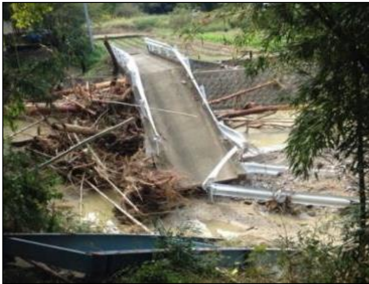
橋梁の被災(10月 台風21号 大阪府岸和田町)
