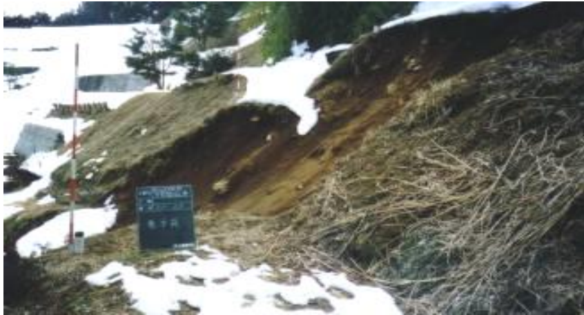
斜面崩壊により耕作道が崩落
