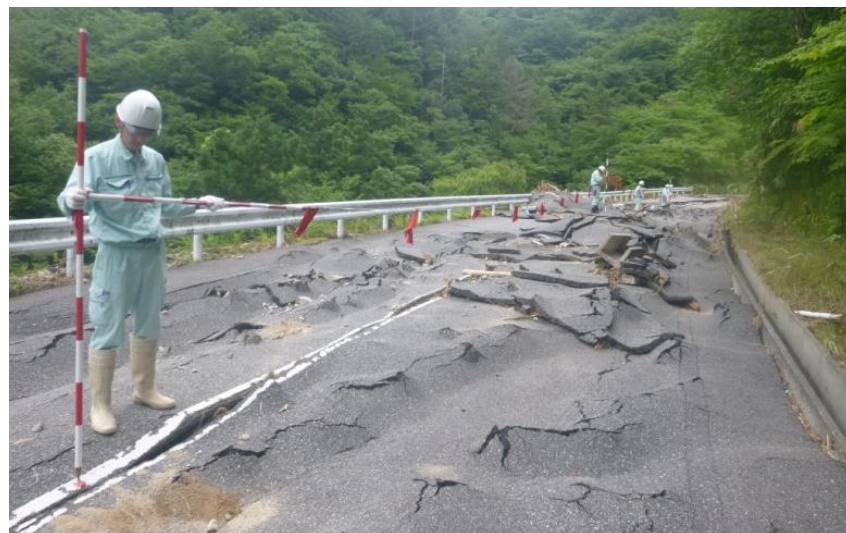
農道の被災(7月 梅雨前線 島根県浜田市)
