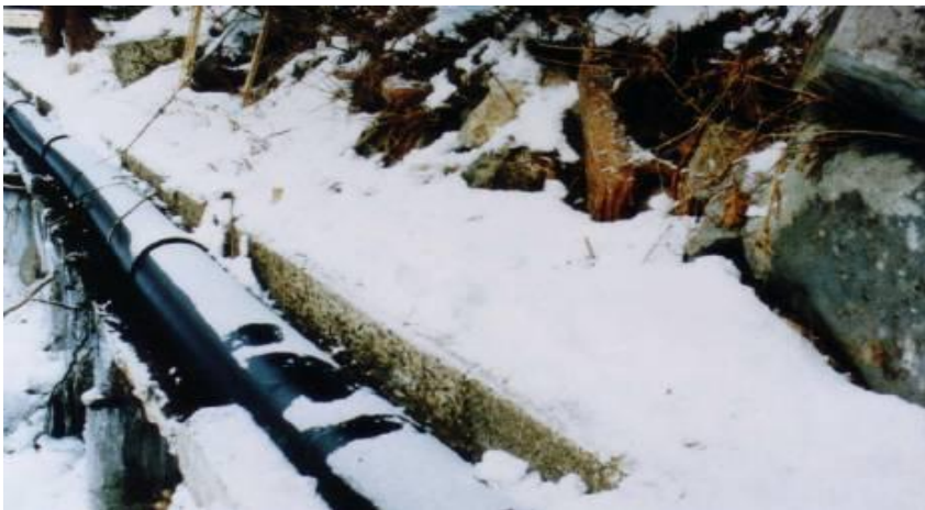
河川増水により現場打水路が被災
