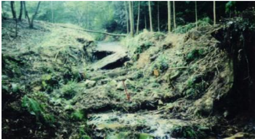
豪雨により余水吐水路が被災
