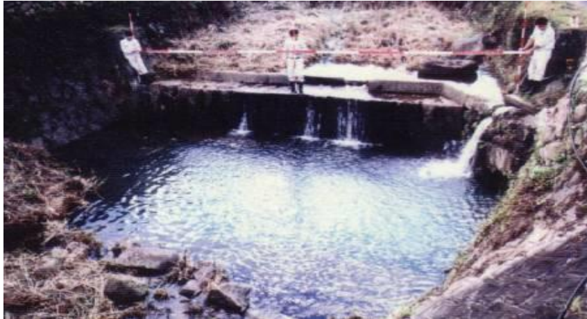
豪雨により深掘れし、水叩部が流失
