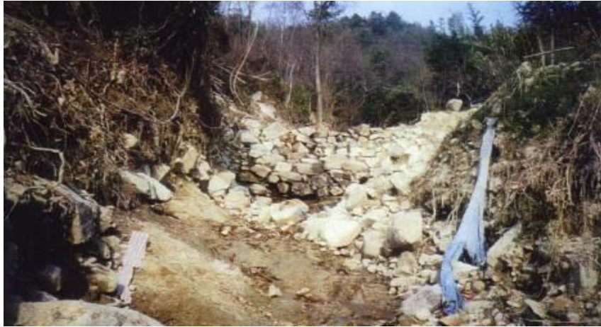
異常出水により新たな水衝部が出現
