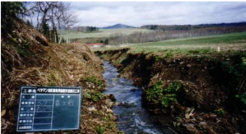
豪雨により水路の河床洗堀、法面崩壊
