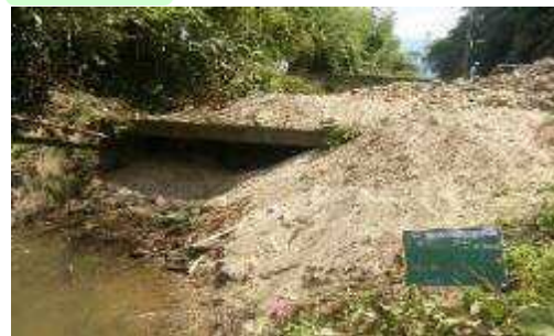
土砂が堆積した水路
