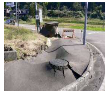
地震により被災した集落排水施設
