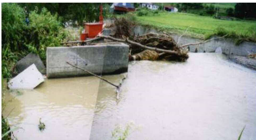
豪雨により、操作部及び護岸が被災
