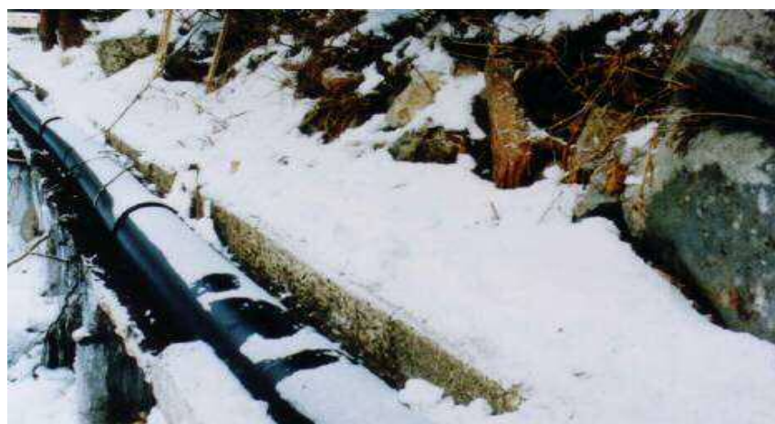
河川増水により現場打水路が被災
