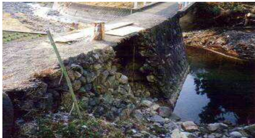
豪雨により石積法面崩壊
