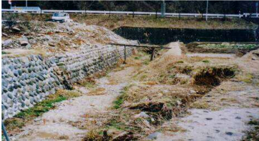
河川氾濫により用水路に土砂堆積
