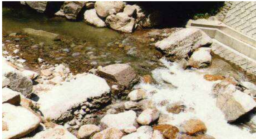
豪雨により堤体及び護岸が崩壊
