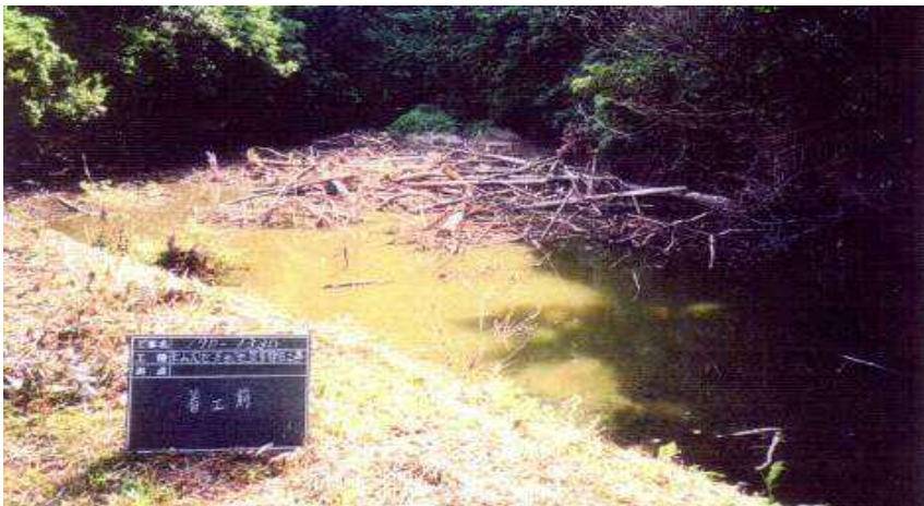
豪雨により土砂及び流木が流入
