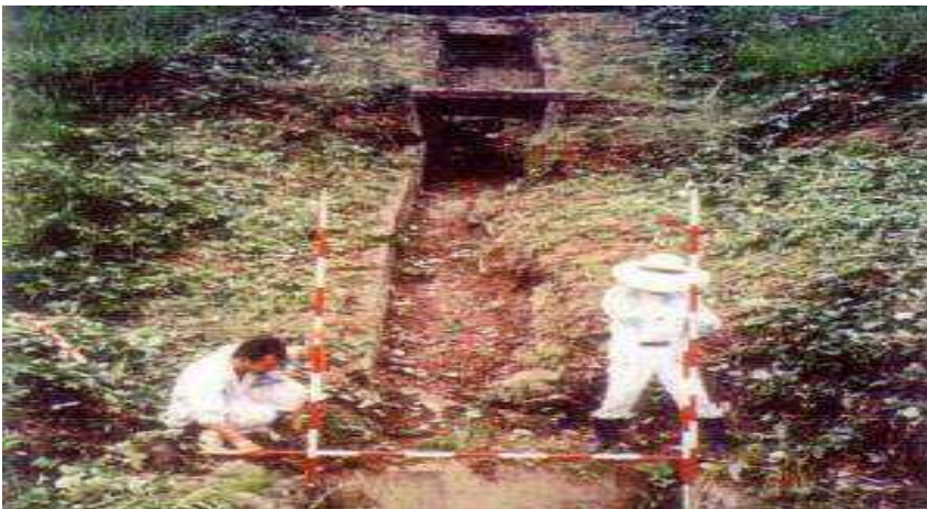
豪雨により余水吐が被災
