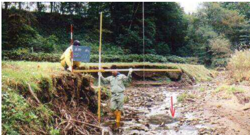
豪雨により排水路法面が崩壊
