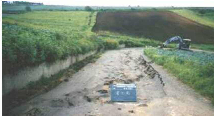
上層、下層路盤の流失及びASの陥没
