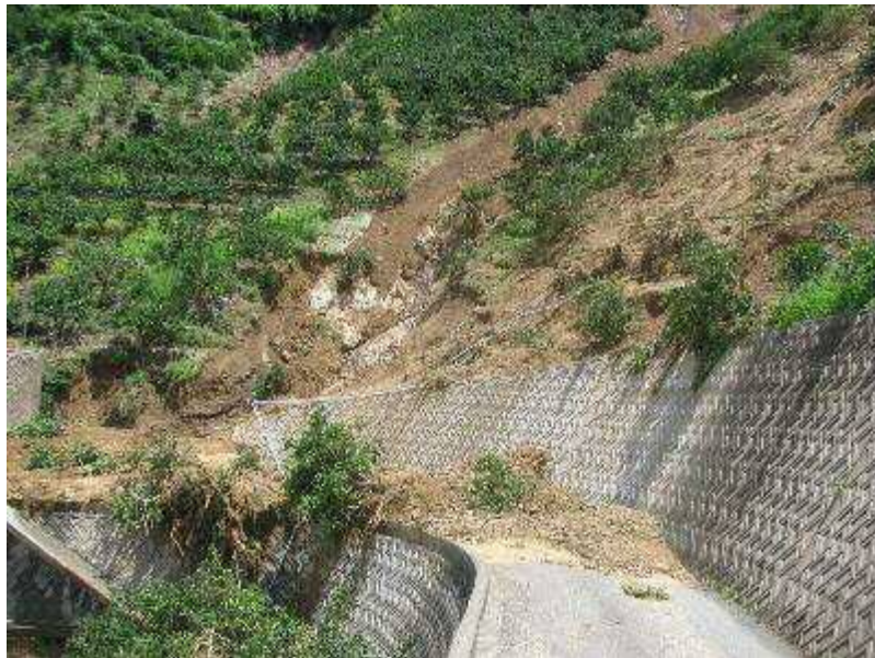
農地と農道の被災(7月 梅雨前線 愛媛県宇和島市)
