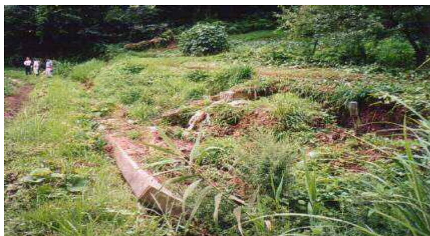
排水路護岸兼用の擁壁が転倒
