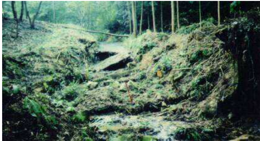
豪雨により余水吐水路が被災
