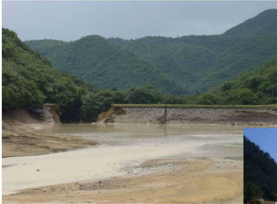
豪雨によりため池堤体が決壊
