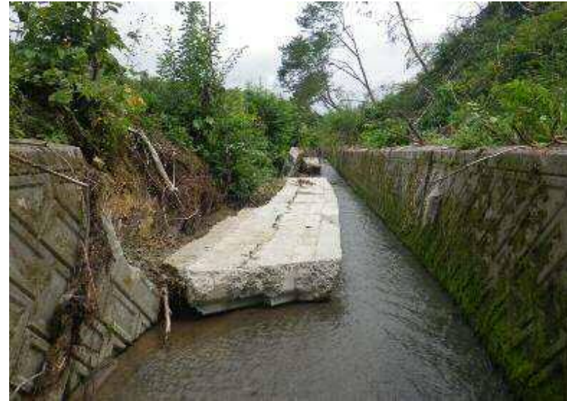
水路の被災(7月 梅雨前線 北海道美瑛町)
