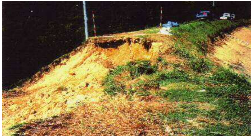
後法面が滑落しパイピングが発生
