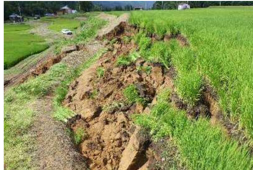
農道の被災(5月 長野県北部地震 長野県栄村)
