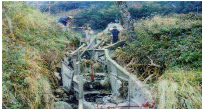
豪雨により土砂の流失及び水路崩壊
