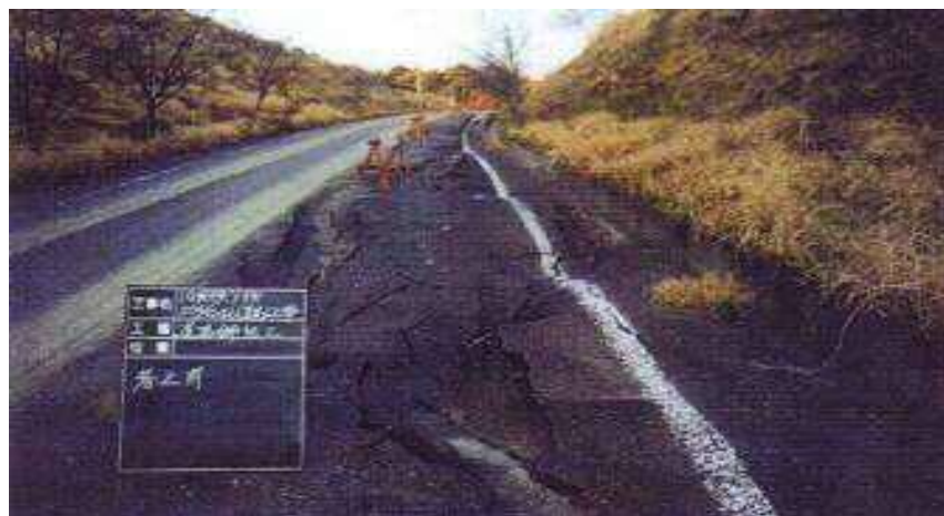
豪雨により路盤及び舗装が被災
