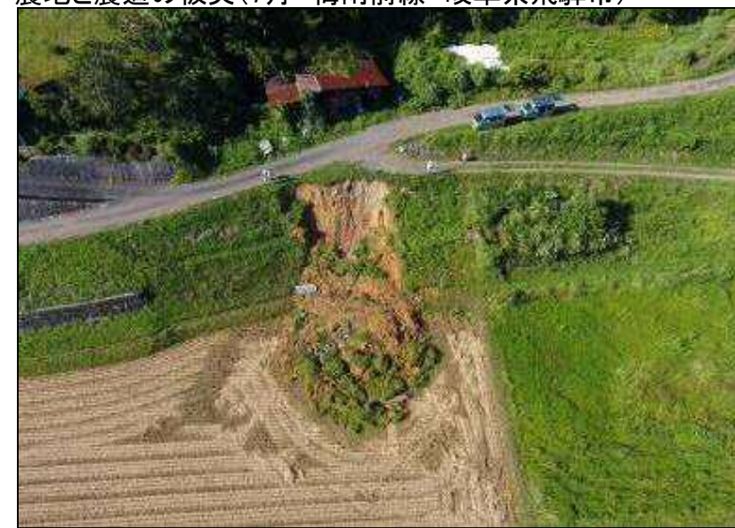
農地と農道の被災(7月 梅雨前線 山口県岩国市)
