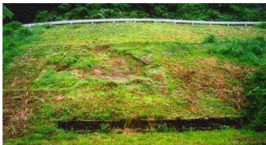
豪雨により道路法面崩落
