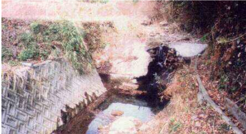
豪雨により練石積堰が洗堀
