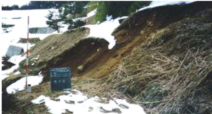
斜面崩壊により耕作道が崩落
