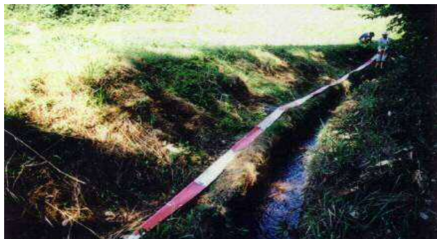
豪雨により越水し排水路法面の崩壊
