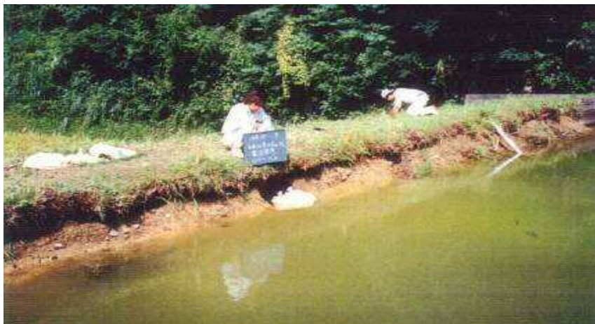
前法面が滑落し、堤体に空洞発生
