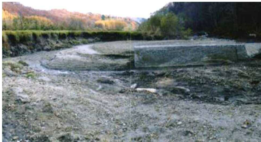
豪雨により頭首工左岸部が被災
