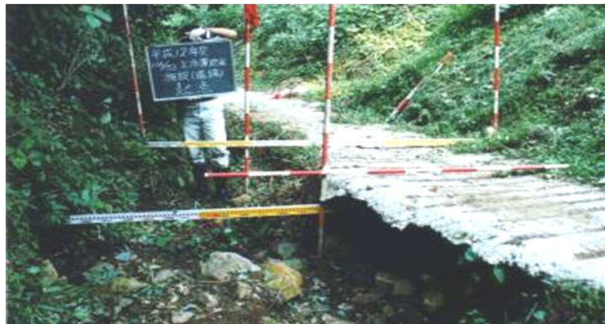
排水路護岸兼用の道路法面崩壊
