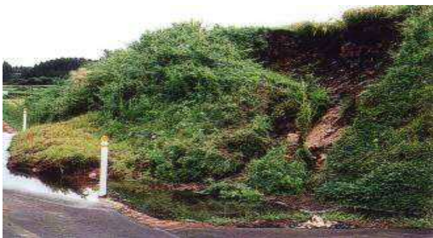
道路法面の崩落
