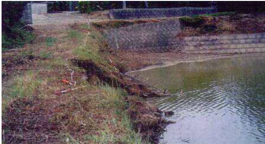
異常出水により斜樋、底樋が被災
