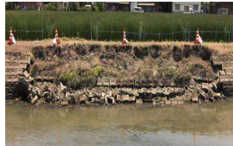
水路の被災(6月 梅雨前線 熊本県八代市)
