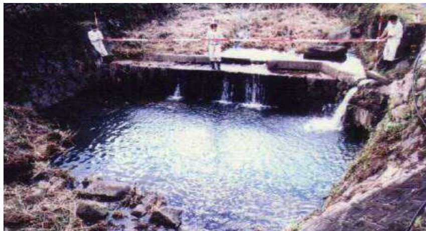
豪雨により深掘れし、水叩部が流失
