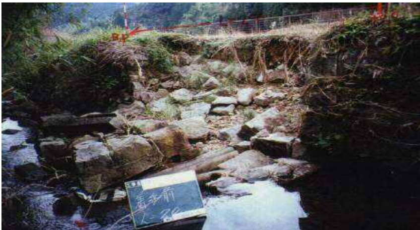
豪雨により頭首工護岸が被災
