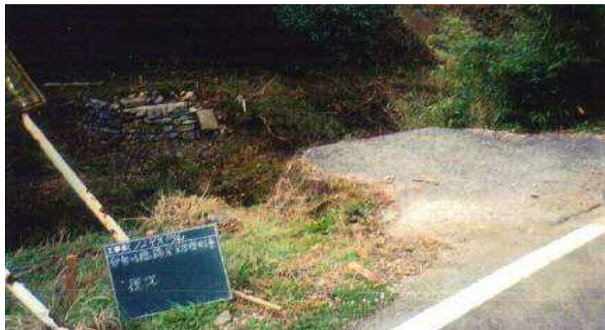
異常出水により木造橋が流失
