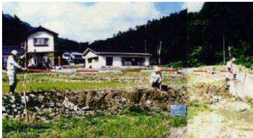
豪雨により石積畦畔崩壊
