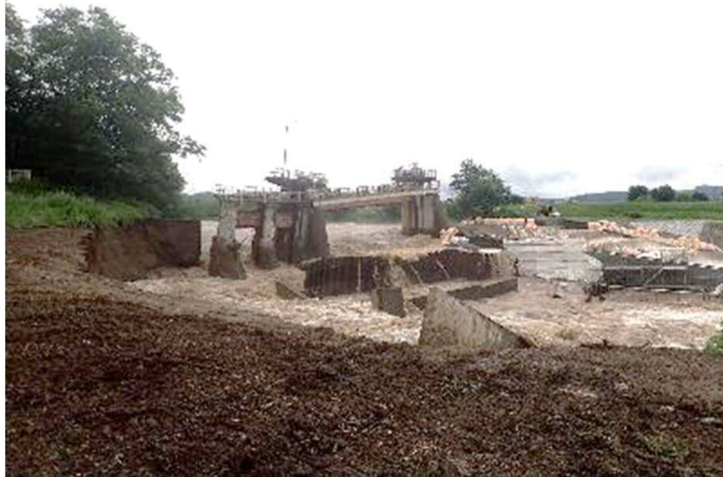
頭首工の被災(7月 梅雨前線 北海道北見市)
