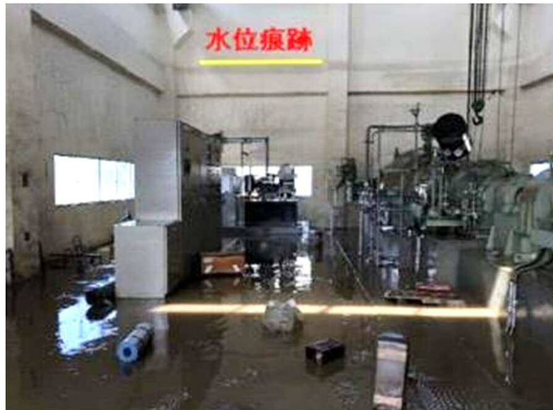
排水機場の被災(7月 梅雨前線 岡山県倉敷市)
