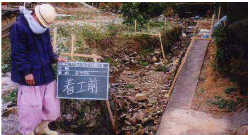
用排兼用水路護岸が被災
