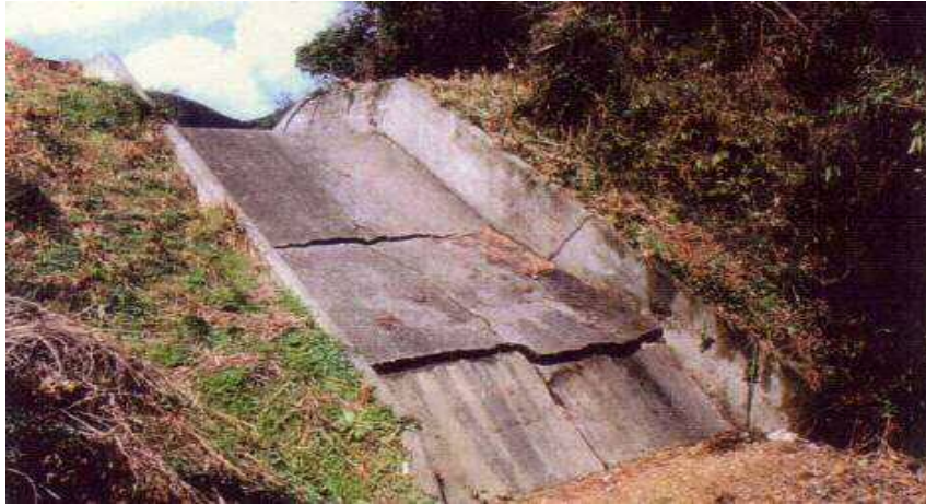
豪雨により余水吐が被災
