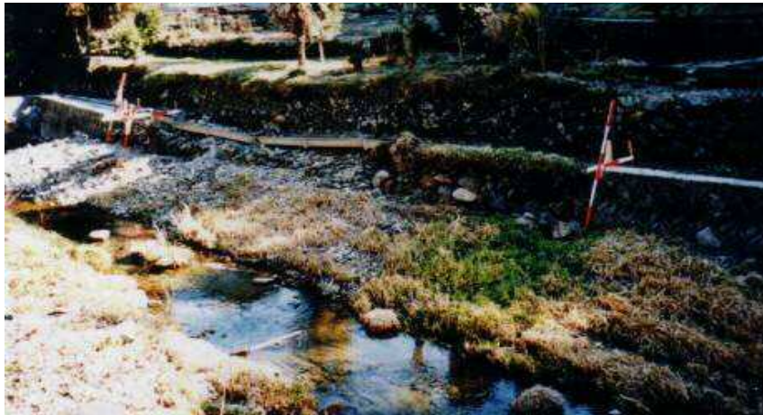
河川の氾濫により水路、護岸が被災
