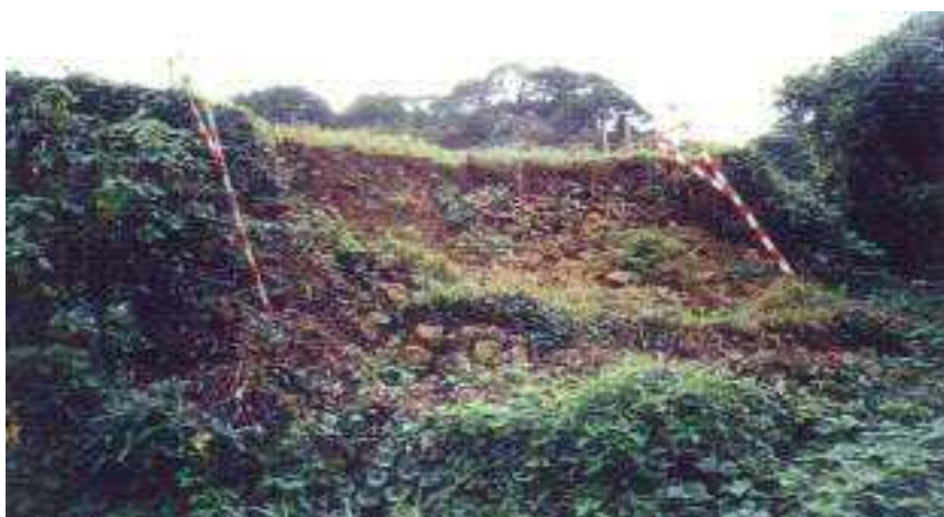
豪雨により畦畔崩壊
