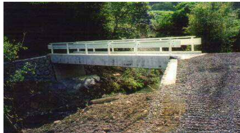
当該被害洪水を対象として復旧
