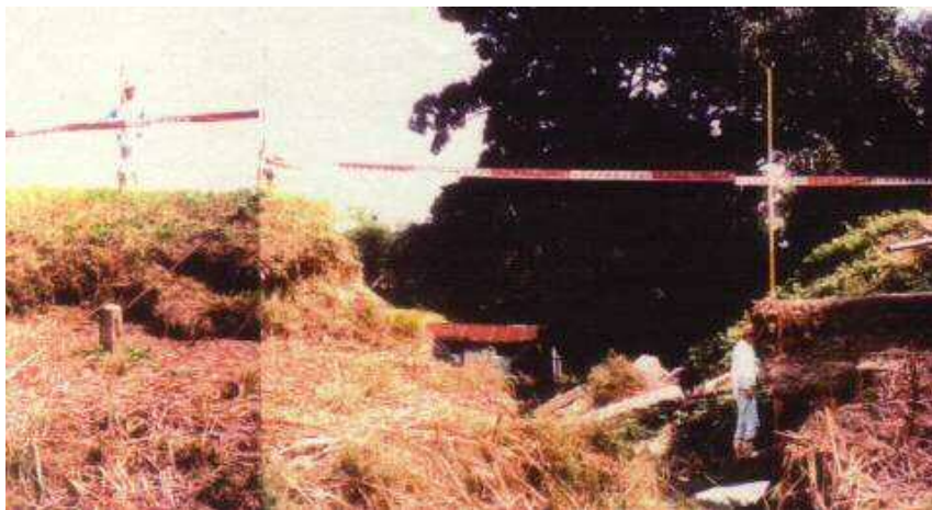
余水吐及び堤体の一部が決壊
