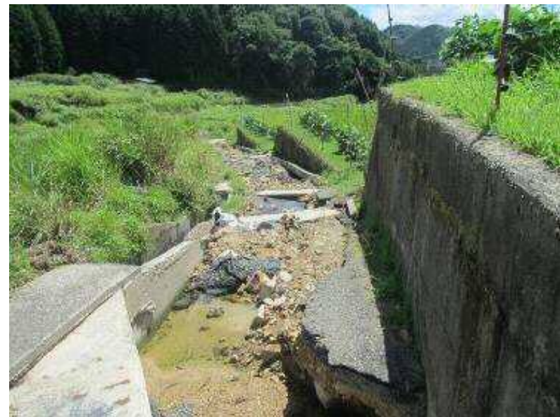
農道の被災(7月 梅雨前線 大阪府豊能郡豊能町)
