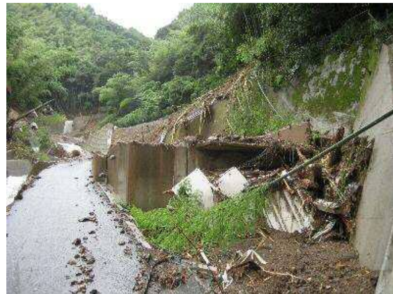
揚水機場の被災(7月 梅雨前線 愛媛県宇和島市)
