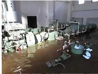
排水機場の浸水 (宮城県角田市)
