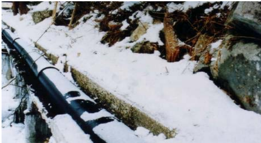
河川増水により現場打水路が被災
