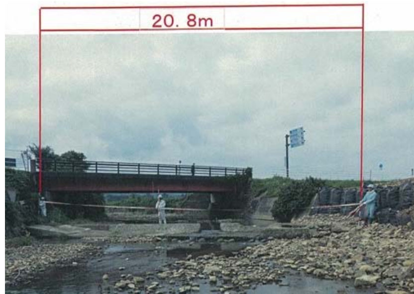
頭首工の被災(6月 熊本県苓北町)
