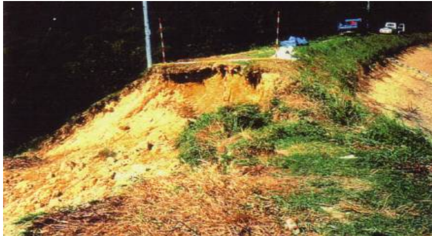
後法面が滑落しパイピングが発生
