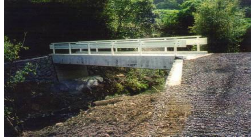
当該被害洪水を対象として復旧
