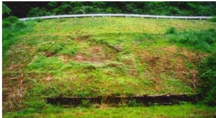
豪雨により道路法面崩落
