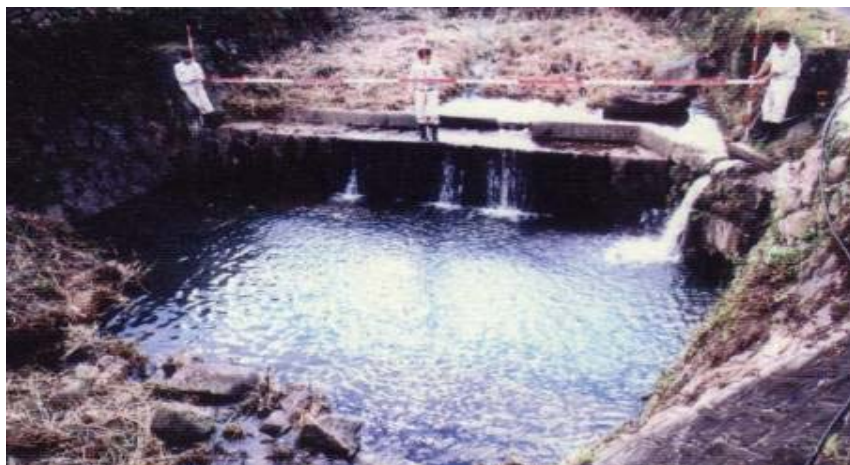
豪雨により深堀れし、水叩部が流失
