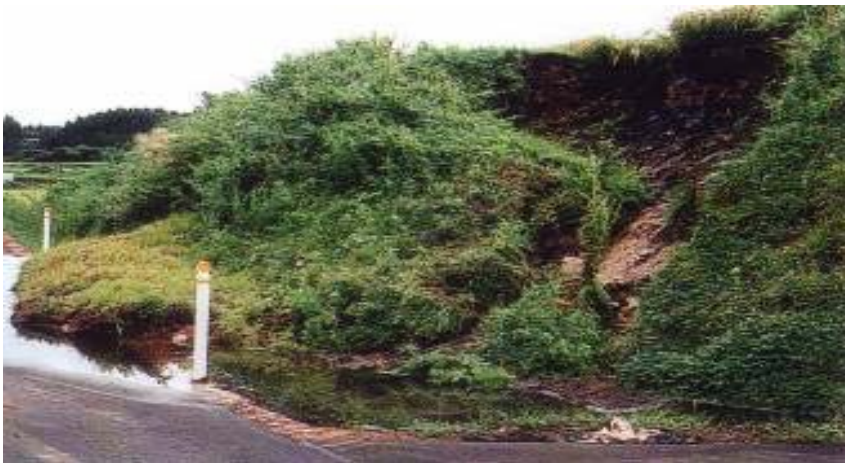
道路法面の崩落
