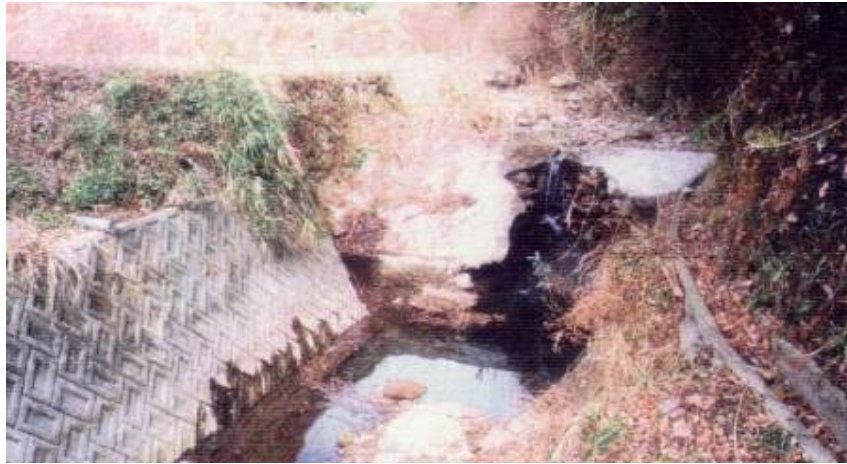
豪雨により練石積堰が洗堀
