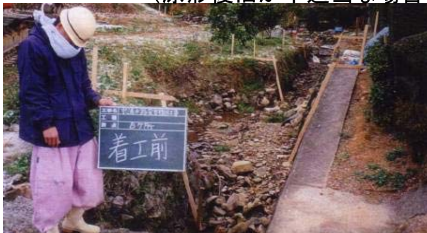
用排兼用水路護岸が被災
