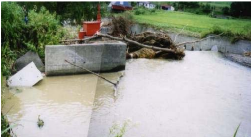
豪雨により、操作部及び護岸が被災
