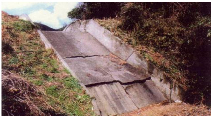
豪雨により余水吐が被災
