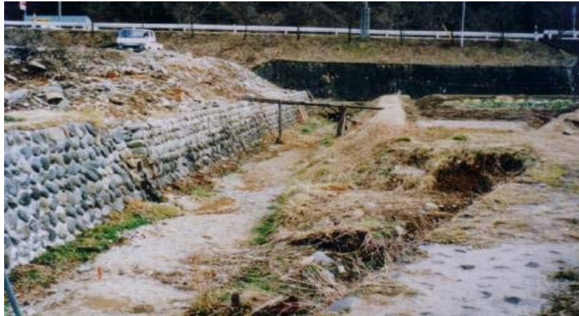
河川氾濫により用水路に土砂堆積
