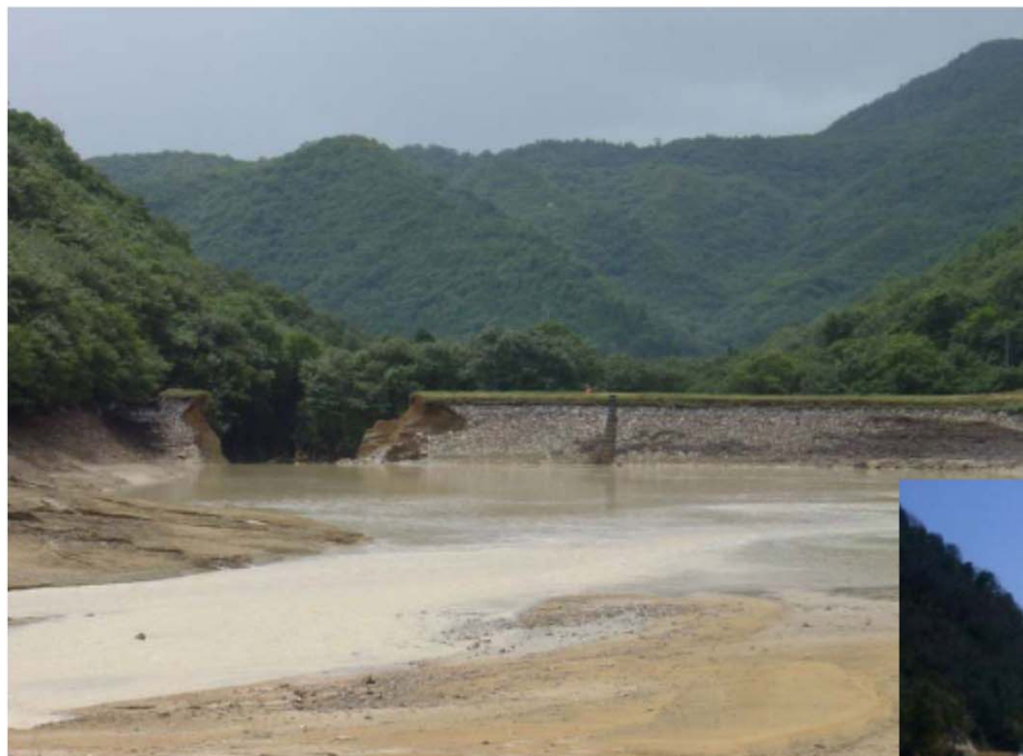
豪雨によりため池堤体が決壊
