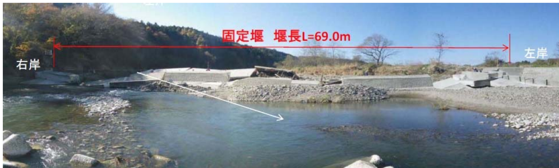
頭首工の被災(9月 宮城県加美町)
