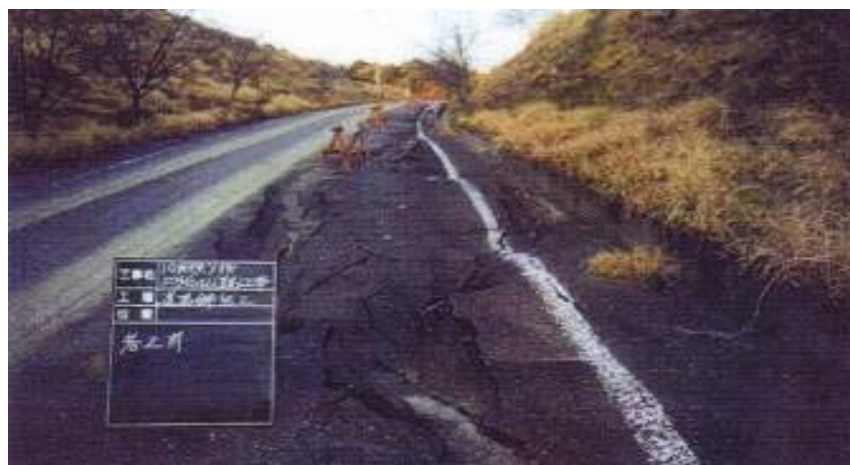
豪雨により路盤及び舗装が被災
