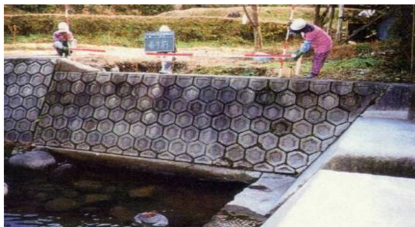
河床が深堀れし、ブロック基礎が露出
