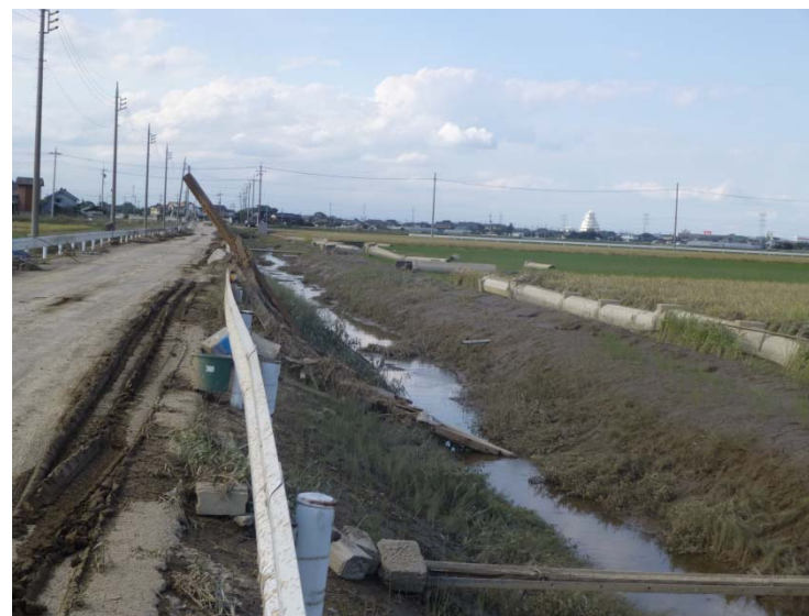
水路の被災(9月 茨城県常総市)
