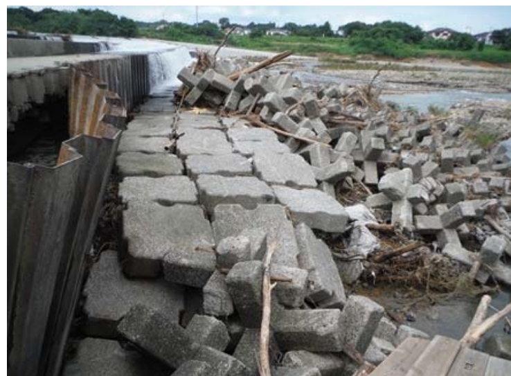
頭首工の被災(9月台風18号 埼玉県篠山市)
