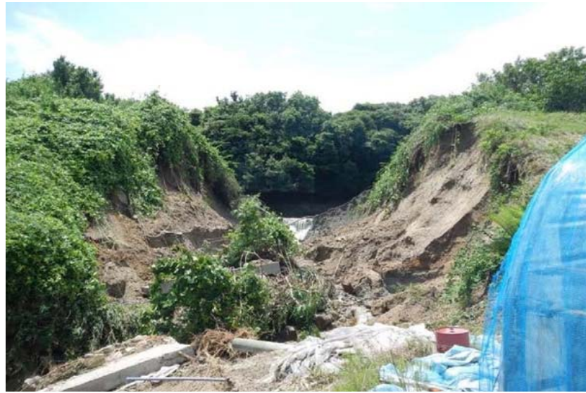
ため池の被災(7月 兵庫県淡路市)
