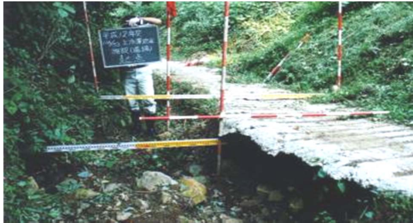
排水路護岸兼用の道路法面崩壊
