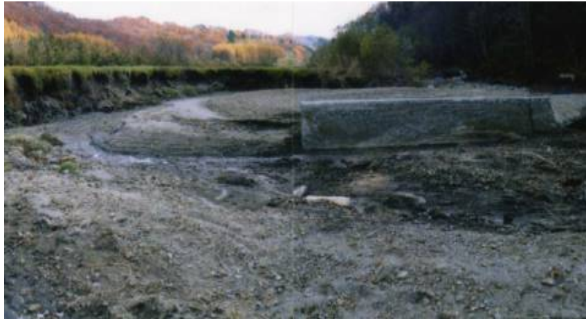
豪雨により頭首工左岸部が被災
