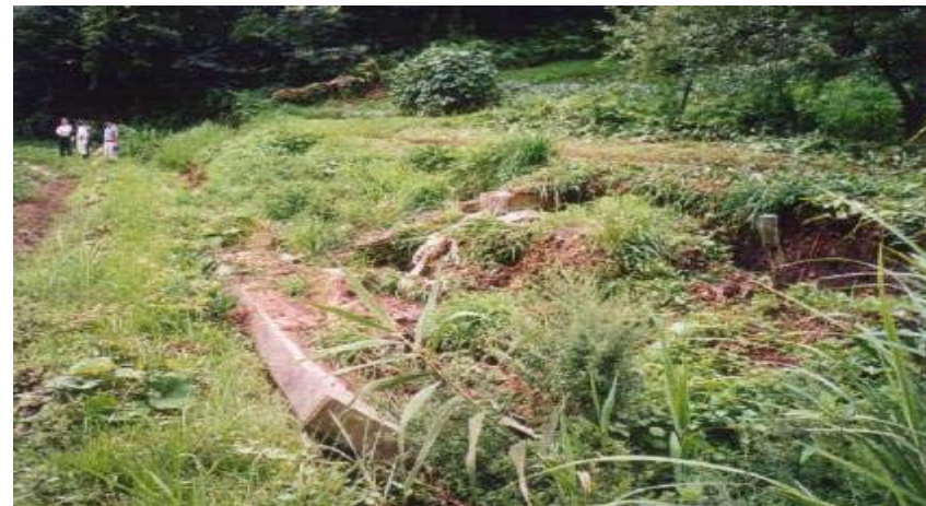
排水路護岸兼用の擁壁が転倒
