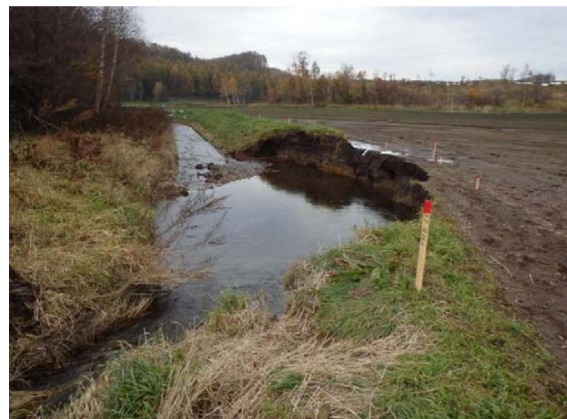
水路の被災(10月 北海道美幌町)
