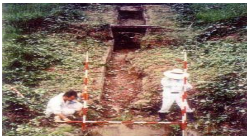
豪雨により余水吐が被災
