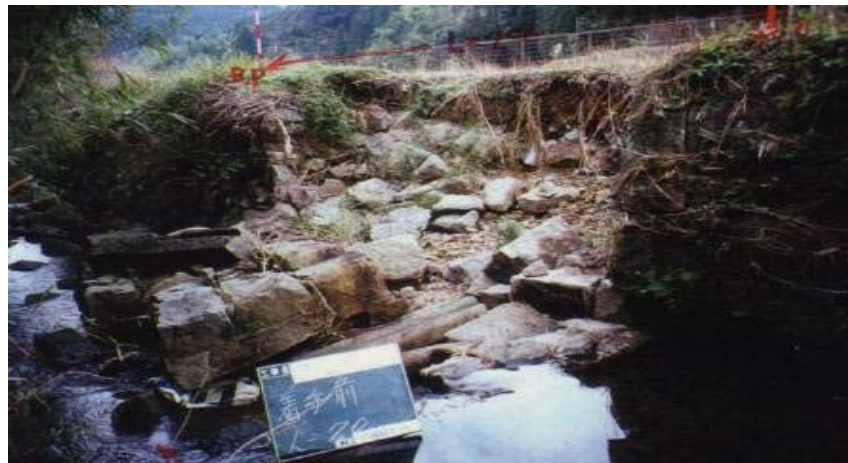
豪雨により頭首工護岸が被災
