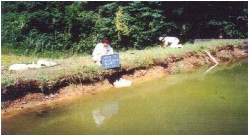
前法面が滑落し、堤体に空洞発生
