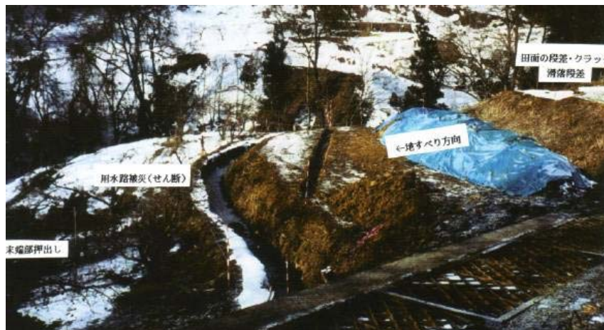
地すべりにより農地の滑落、水路被災
