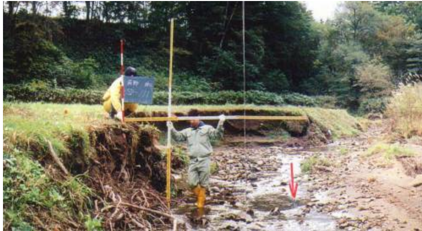
豪雨により排水路法面が崩壊
