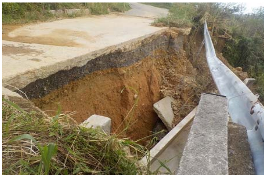
農道の被災(8月 台風15号 沖縄県石垣市)
