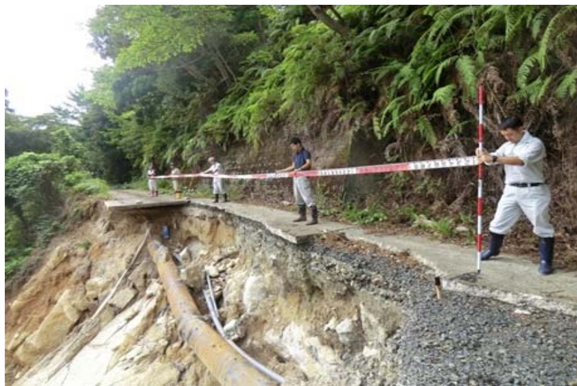
パイプラインの被災(7月 鹿児島県屋久島町)
