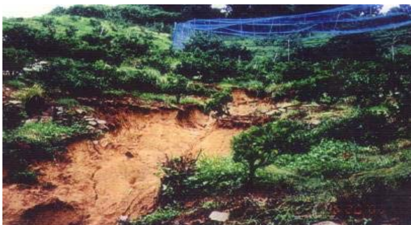
異常出水により農地が被災
