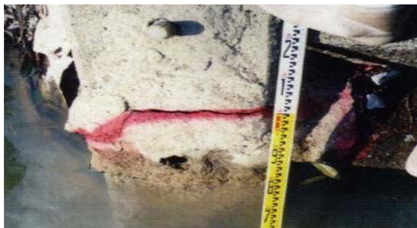
地震による斜樋き裂により取水不能
