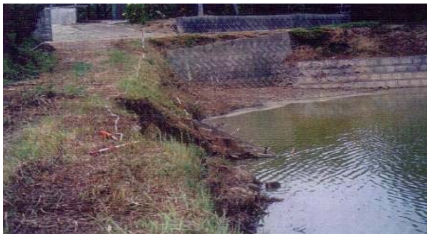
異常出水により斜樋、底樋が被災
