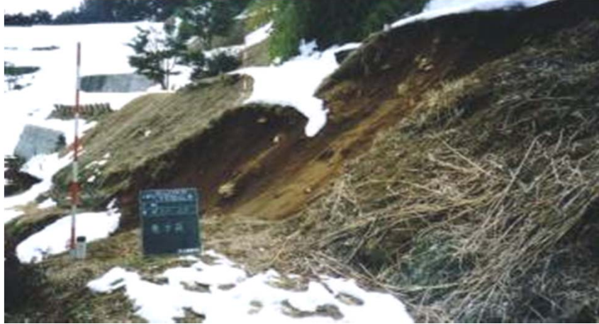
斜面崩壊により耕作道が崩落
