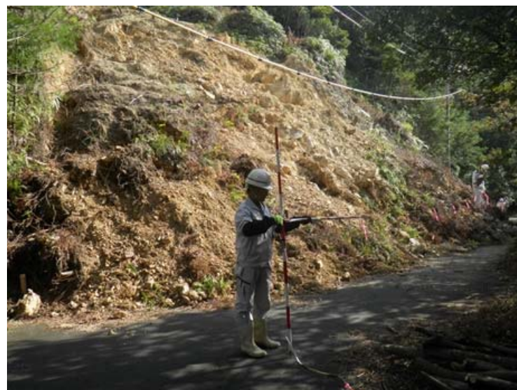
農道の被災(9月 三重県鳥羽市)
