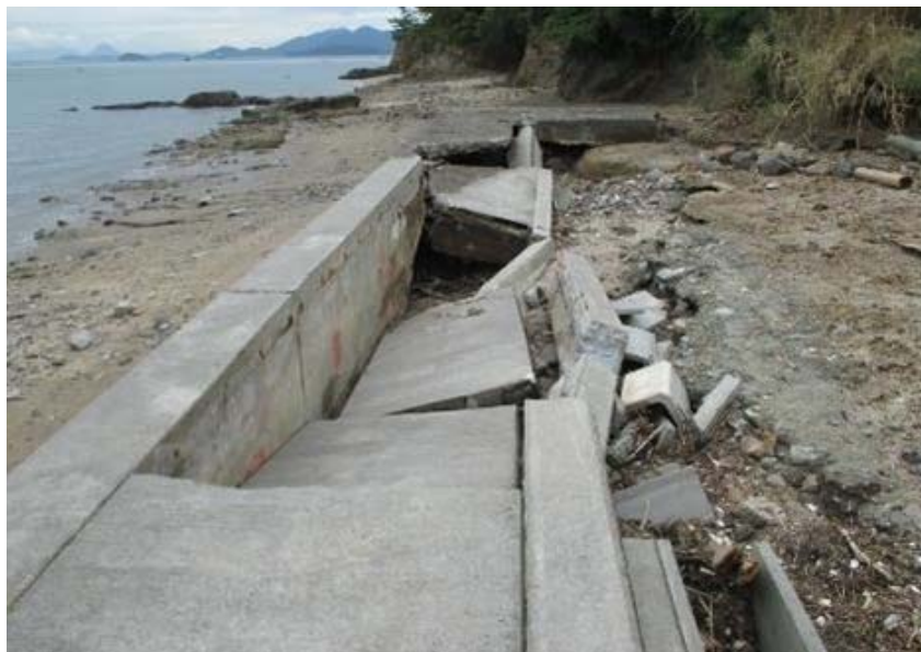
海岸保全施設の被災(台風11号 7月 香川県三豊市)
