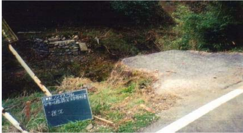
異常出水により木造橋が流失
