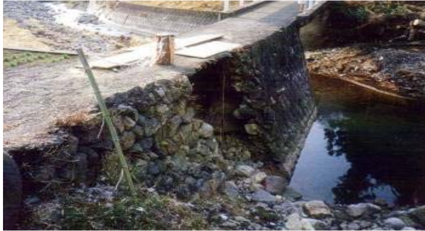
豪雨により石積法面崩壊
