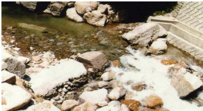
豪雨により堤体及び護岸が崩壊
