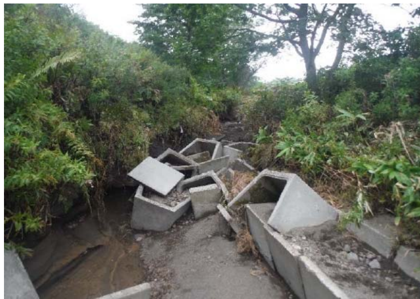
水路の被災(8月 北海道弟子屈町)
