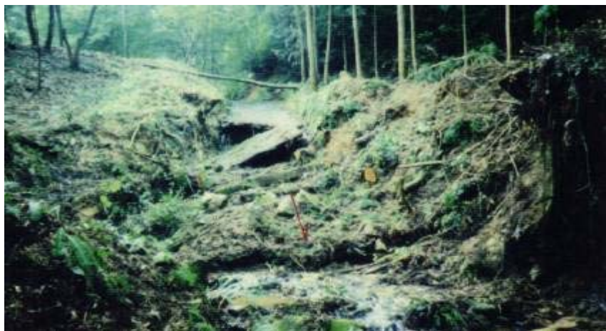
豪雨により余水吐水路が被災
