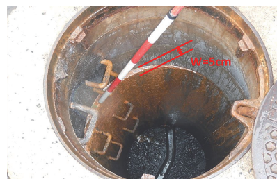
(マンホールのズレ)
