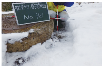
(マンホールが隆起?)
