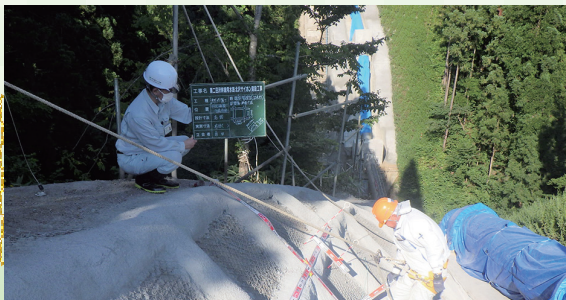
本会技術員による現場出来高確認 (第二田沢幹線水路北沢サイホン建設工事法面保護工)
