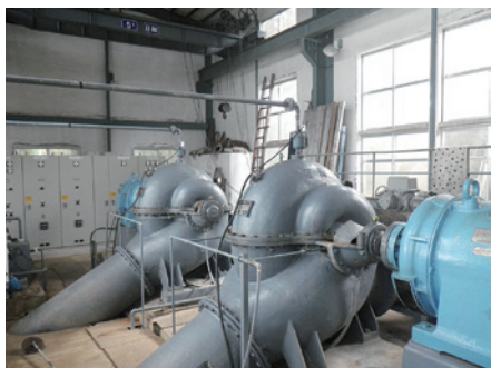
野村揚水機場
