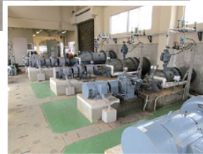
天王西排水機場
