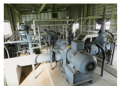
▲久米岡揚水機
