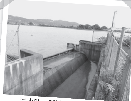
洪水吐 越流部転倒式ゲート
