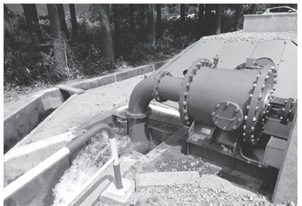
▲畑野小水力発電所(にかほ市)
