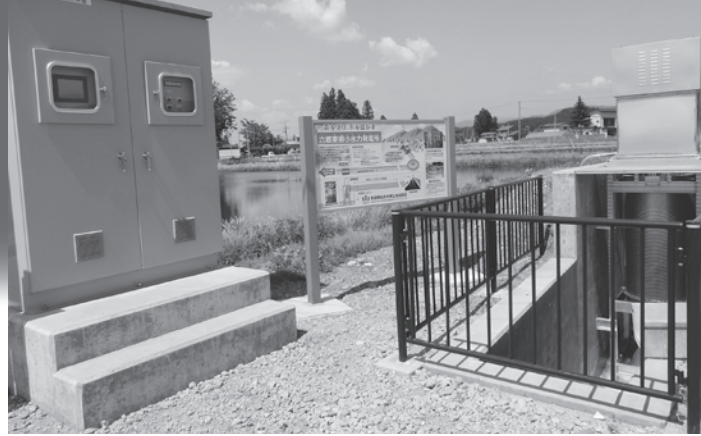
▲六郷東根小水力発電所(美郷町)
