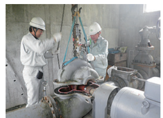
写真-8 主ポンプ
