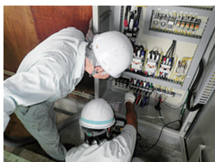
写真-5 電気設備
