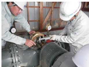
写真-1 主ポンプ
