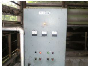
写真-2 電気設備の劣化状況 ・耐用年数20年を超過しています。 ・適正化事業で更新できます。
