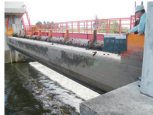
写真-3 頭首工の劣化状況 ・ゲートの塗装が剥離しています。 ・適正化事業で塗装できます。
