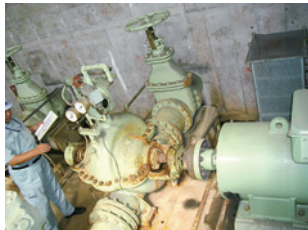
写真-1 揚水機場の劣化状況 ・ポンプの塗装が剥離しています。 ・適正化事業で塗装することができます。
