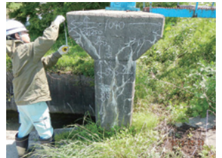
写真-4 水門の劣化状況 ・門柱にひび割れが認められます。 ・適正化事業で門柱を補修できます。
