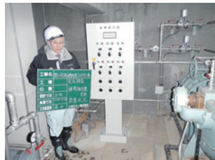
写真-6 電気設備の整備補修 ・電気設備の更新をしました。
