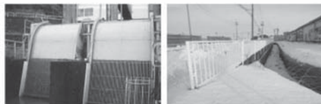
除塵機等、維持管理施設
