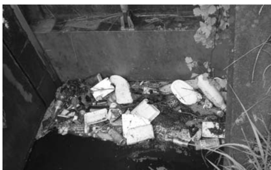
<OM土地改良区が管理する分水工>
