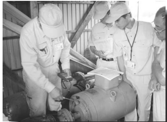
▲モーターの点検ポイント
